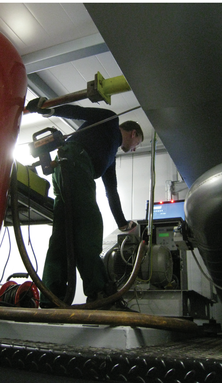
Mittalaitteet sijoitettiin kattilan päälle kaasukanavan viereen.
