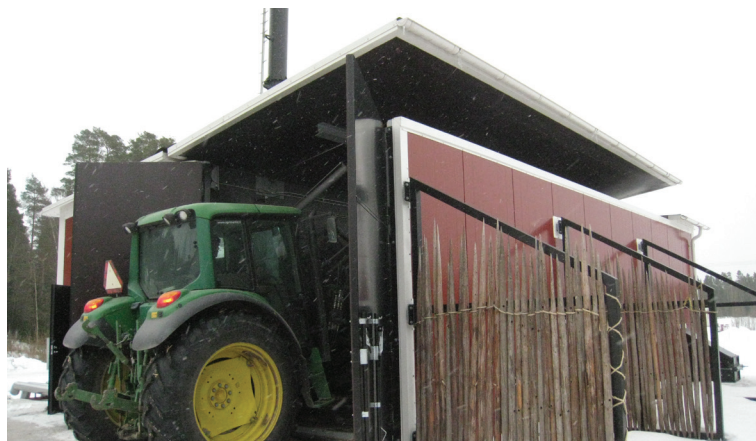
Väkiparran tilan lämpölaitos on moduuliratkaisu, jonka valmistaja on Bio Mobitek OÜ. Laitos on otettu käyttöön vuonna 2012. Varasto-osan kattoa nostetaan täyden ajaksi.
