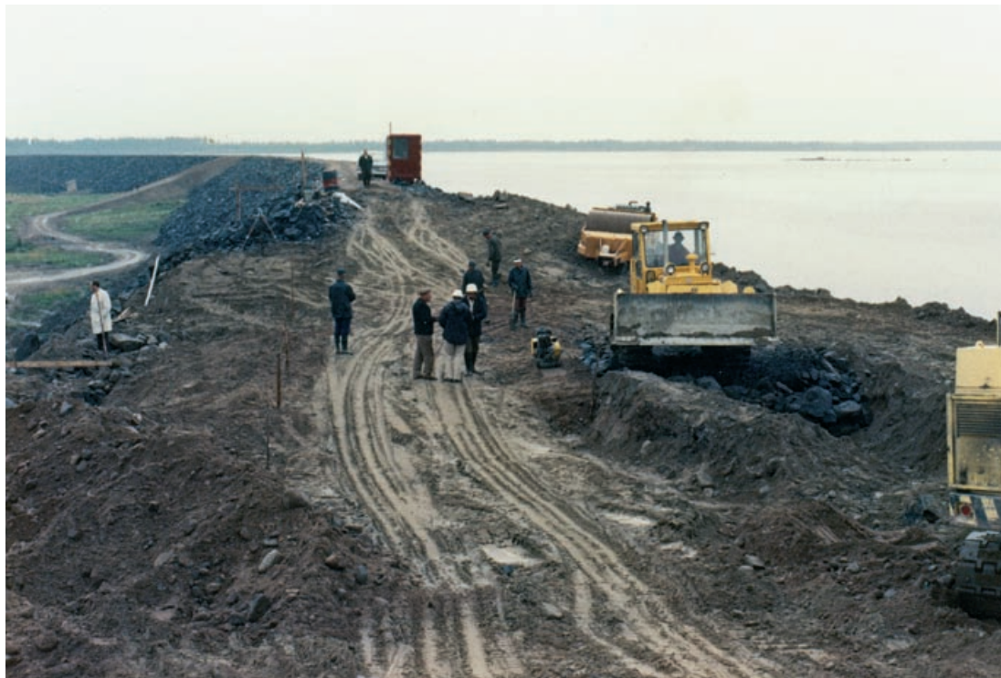
Uljuan altaan imuruoppausvesien täyttöallas sortui ja korjaustöitä jouduttiin tekemään vuonna 1970. Kuvassa ovat korjaustyöt käynnissä toukokuussa 1970. (POHJOIS-POHJANMAAN ELY-KESKUS)
