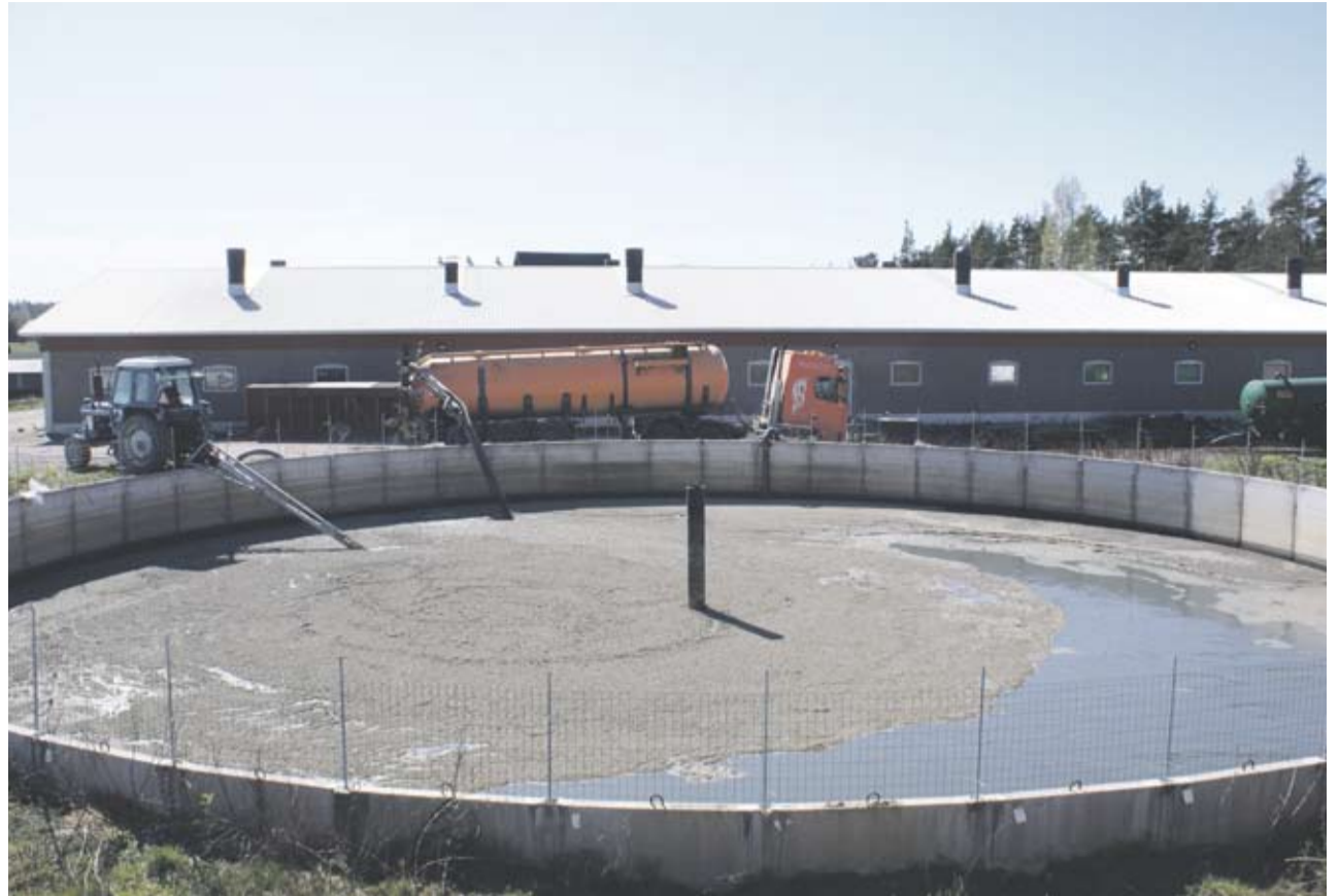
Kotieläintilan hyvään perusrakenteeseen kuuluvat huolella rakennetut lantavarastot ja riittävän suuret jaloittelutarhat.
