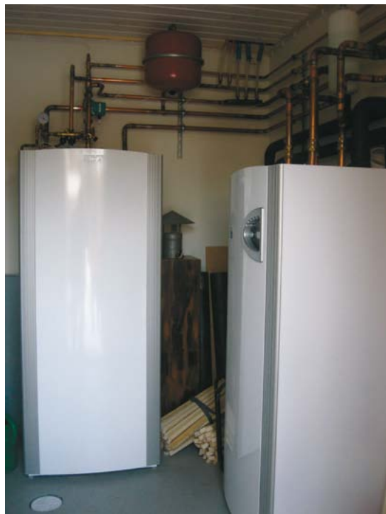
Maalämpöpumpun voi asentaa myös ulkorakennukseen. Kuva Matti Pollari
