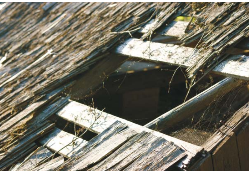
Katto on rakennuksen korjaustöistä kiireellisimpiä. Kuva Markku Saarela
