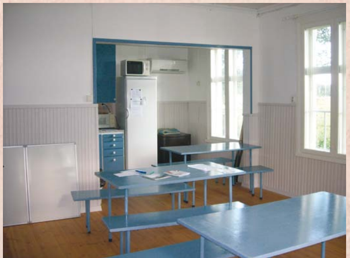
Pumpun sisäyksikkö keittiön seinällä. Kuva Hanna Poropudas
