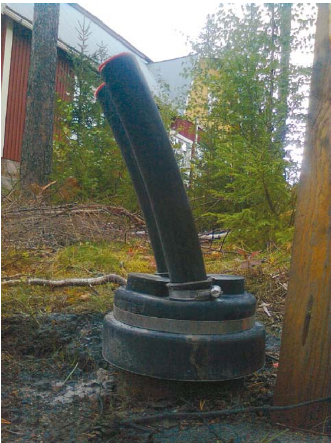
Lämpökaivo piiloutuu Västilän Voimantalon maastoon varsin sujuvasti. Kuva Matti Pollari
