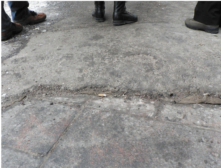
Kuva 42. Kylmässä valettu asfaltti lohkeilee helposti
