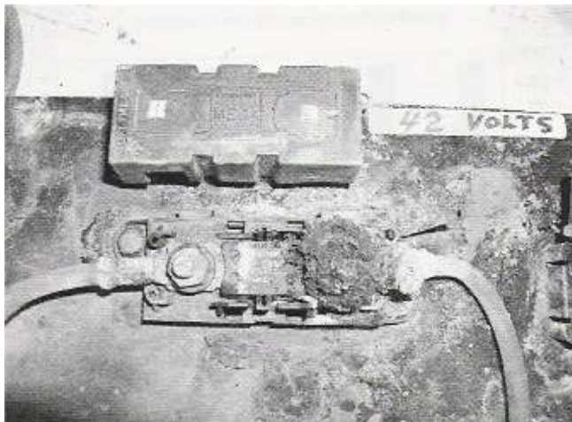
Kuva 6. 42 V järjestelmän vauriot /2, s. 253/.
