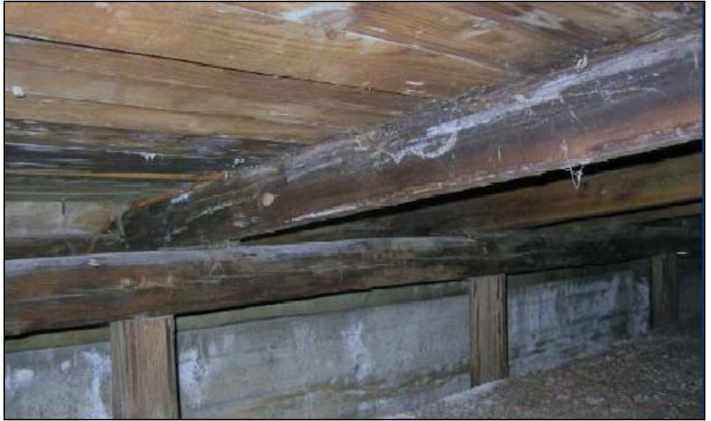
Kuva 5. Vesikaton vuodon aiheuttamaa lahovauriota rakennuksen ullakkotiloissa.
