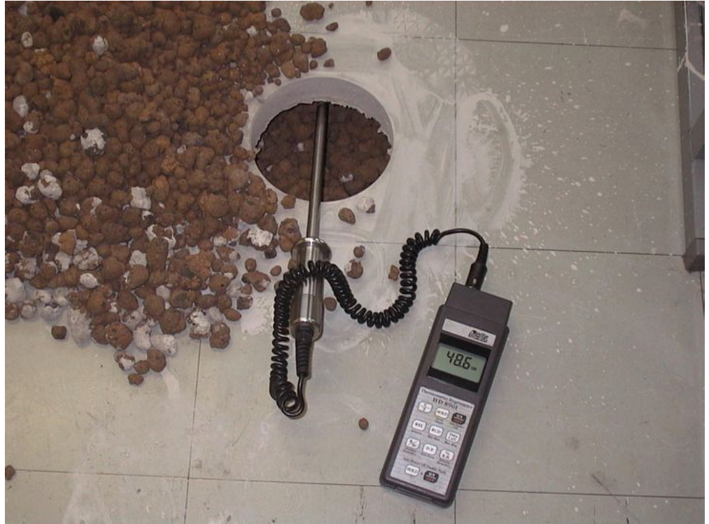
Kuva 3. Lattian kevytsoraeristeen kosteuden mittaus. Kuvassa mittari osoittaa 48,6 % RH, eli eriste on kuivaa.
