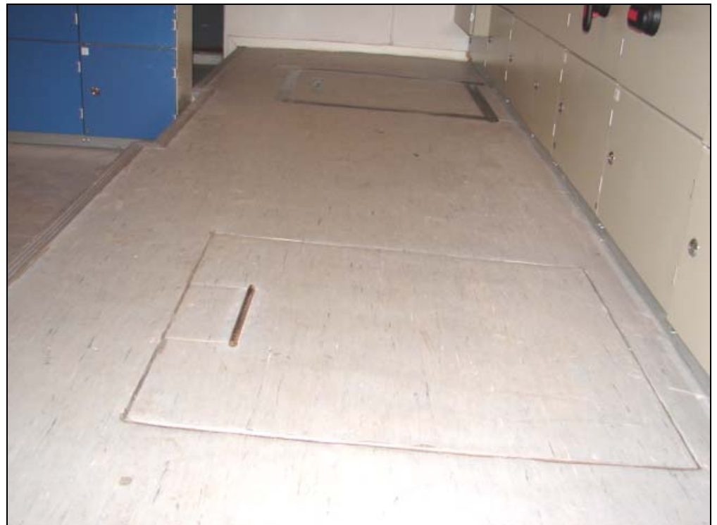
Kuva 7. Kellaritilan sähköpääkeskuksen lattiamateriaalina muovimatto.
