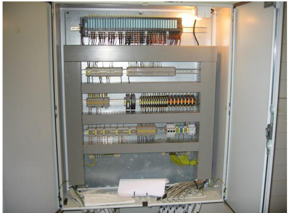
Kuva 3.7. I/O-kortit sisältävä kenttäkotelo kattilasalissa Amel 1:ssä
