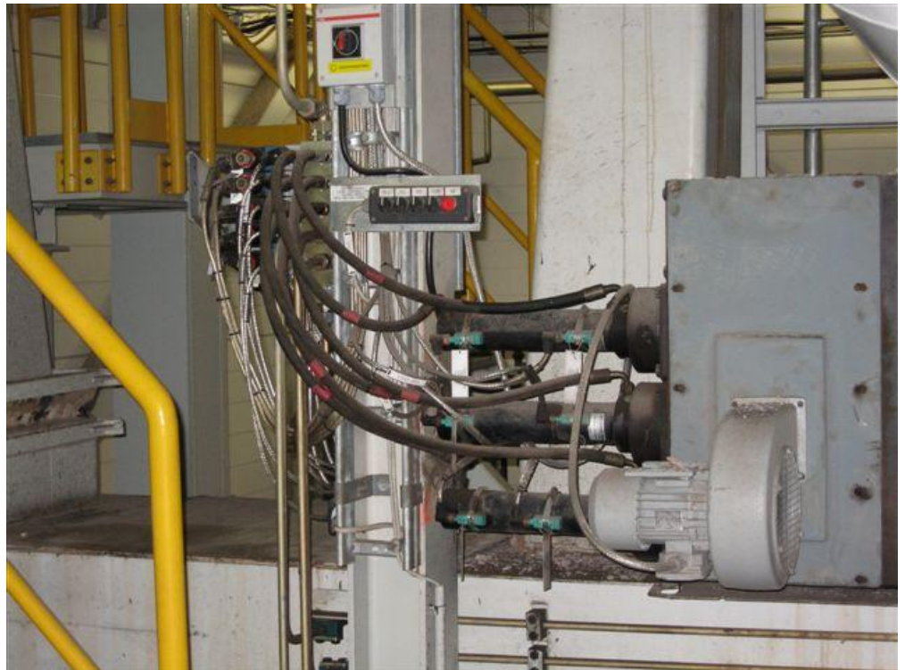
Kuva 4.3. Puhallin asennettuna Amel 1-käyttösylinterien männänvarsitilan sivuseinään
