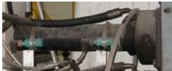
Kuva 4.8. Liikeraja-anturit asennettuna käyttösylinterin ulkopintaan
