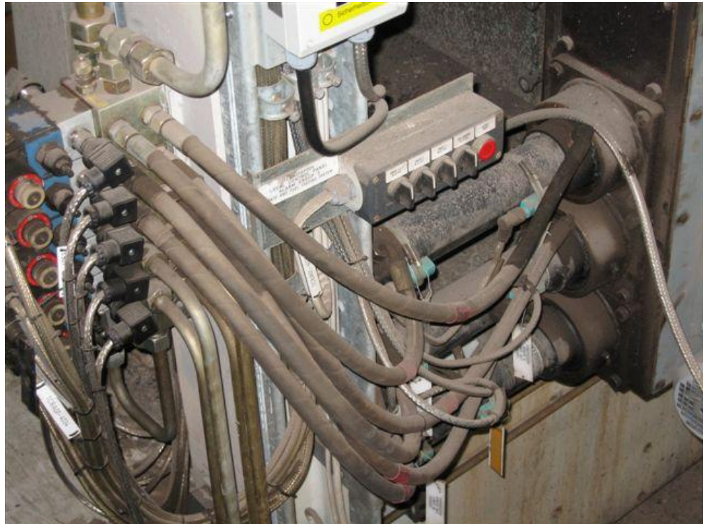
Kuva 3.8. (Suuntaventtiilibloki vasemmassa reunassa) Mittalaatat, painelähtimet ja kaapelit asennettuna Amel 1:ssä
