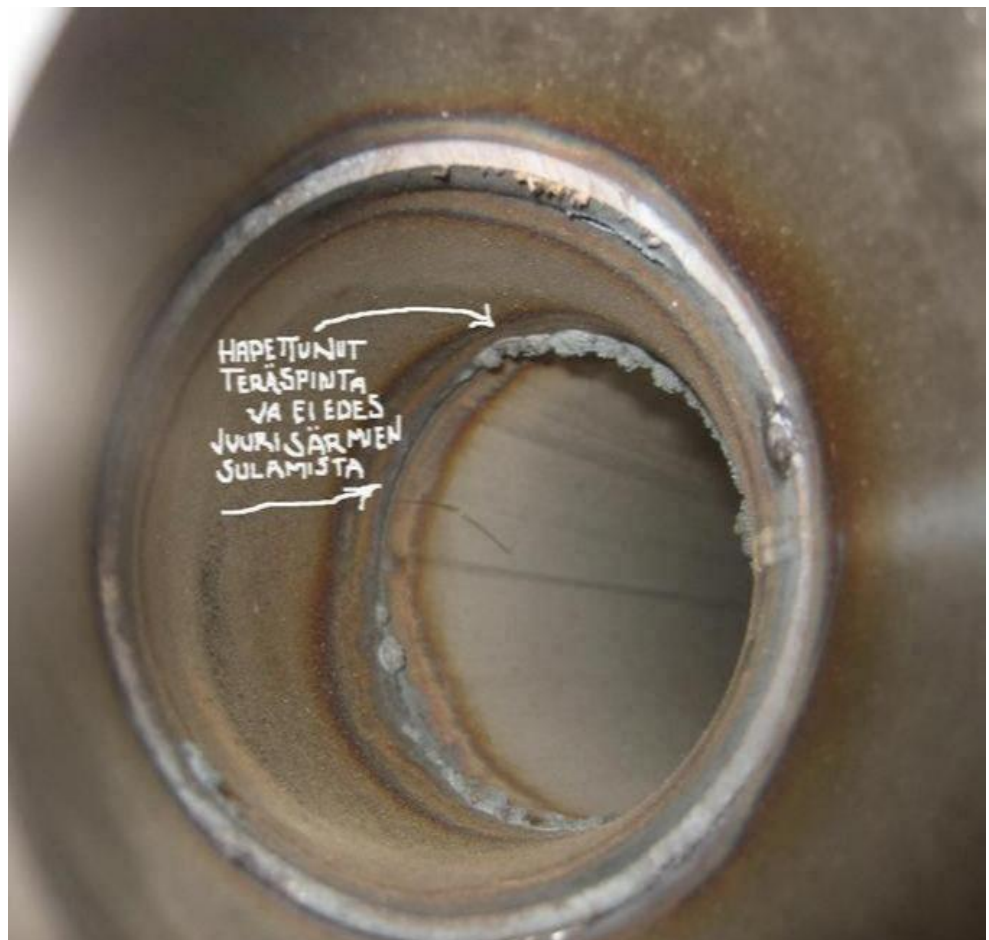
Kuva 12. Ruostumattoman teräsputken sisältä kuvattu juurenpuoli, jossa nähdään juurensuojauksen puuttumisen vuoksi muodostunut kromiköyhä hapettunut teräspinta ja puutteellinen juurisärmien yhteen sulautuminen.
