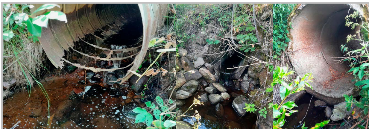
Kuva 59. vasemmalta oikealle: Karpanperäntien haperoitunut rumpu, Jokelan betonitierumpu sekä pellon keskellä oleva betonirumpu.
