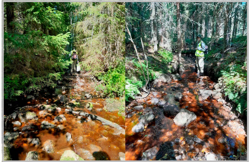
Kuva 115. Virtapaikkojen 62 ja 63 kohdalla uoma on muokattu perkaamalla ja pohja on paikoin hyvin liettynyt.
