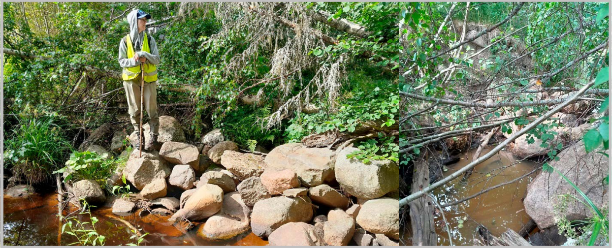
Kuva 84. Noin 300 metriä Ahvenlammentiestä ylävirtaan sijaitsee täydellisen nousuesteen muodostava epämääräinen uimapaikkapato.
