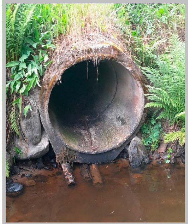
Kuva 6. Huonokuntoinen Lamminpohjantien rumpu muodostaa täydellisen nousuesteen vesieläöille.
