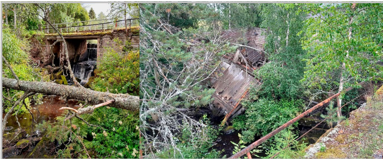
Kuva 66. Kartun myllykosken pato muodostaa täydellisen nousuesteen vesieliöille, ja sen alapuolella on uomaan romahtanut myllyrakennus.
