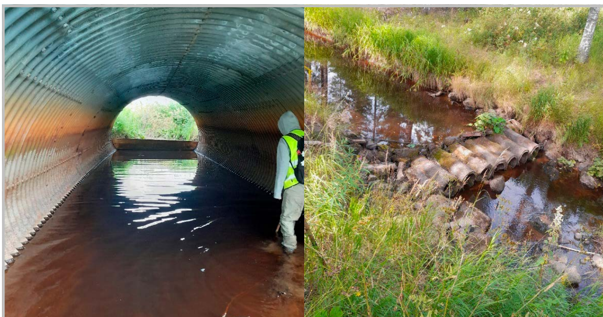
Kuva 83. Ahvenlammentien alittavaa suurta rumpua on yritetty padottaa lankuilla, ja tien yläpuolelta löytyy uimapaikkaa varten tukista rummuista rakennettu pato.
