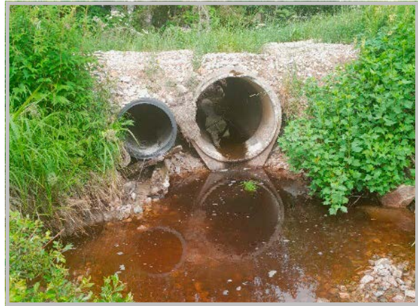
Kuva 40. Mäkysen pihatien rumpu muodostaa merkittävän esteen vesieliöille.
