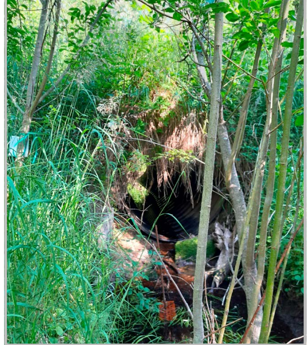
Kuva 37. Vesisuonojaa on aikoinaan suoritettu, vaikka se on kuvan ottamispaikalla lueteltu metsälain erityisen tärkeäksi elinympäristöksi. Yläpuolinen rumpu on nousueste alivirtaama-aikaan.
