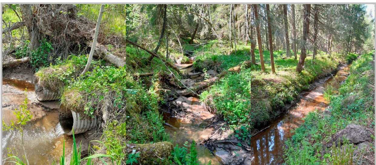
Kuva 123. Kolisevanojan alaosaan kuuluva rumpu, jonka yläpuolelta uoma on luonnontilainen ja luoteltu metsälain erityisen tärkeäksi elinympäristöksi. Kolisevanojan ylittävän autotien yläpuolelta puro on perattu.
