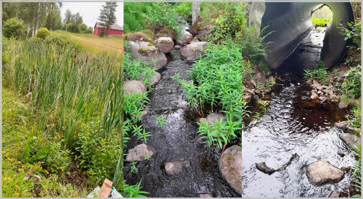
Kuva 12. Railastasonjan yläosilla uoma on paikoin rehevöitynyt ja perattu.
