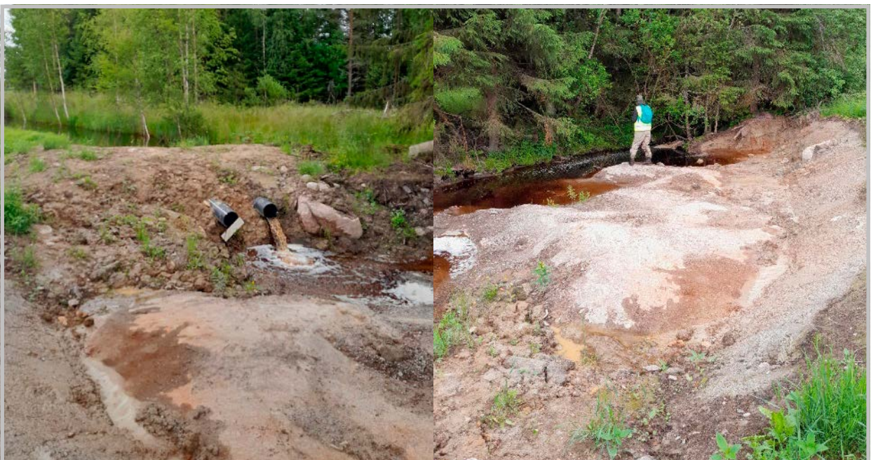
Kuva 33. Uoman tukkiva maapato on aiheuttanut pahan eroosion, kun vesi on korkeammilla virtaamilla virrannut patorakenteen vierestä.
