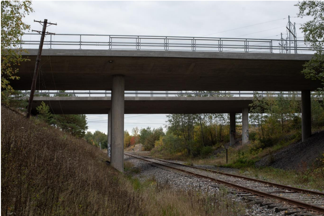
Kuva 151. 1978 siirrettyä linjaa Porvoon ohikulkutien kohdalla. Historiallisesta linjauksesta kohteen erottaa muun muassa suurimittakaavainen maaleikkaus ja sepelitukikerros. Nuoremman linjaosuuden varrella on säilytettyä avojohtoista puhelinlinjaa, joskin nykyisin huonokuntoisena reliikkinä. Mikko Itälahti 24.9.2022.
