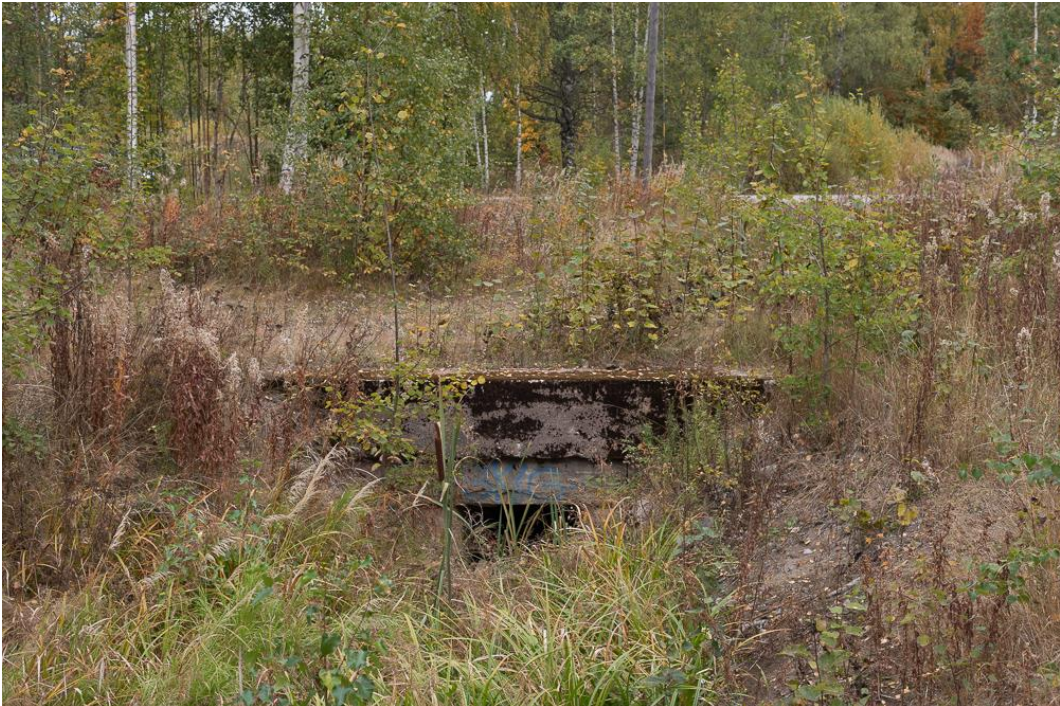
Kuva 153. Betonisella reunapalkilla vahvistettu kivrumpu 1978 Kiialan ja Porvoon välillä tehdyn oikaisun eteläpäässä, Porvoon ratapihan pohjoiskaarteen varrella. Mikko Itälahti 24.9.2022.
