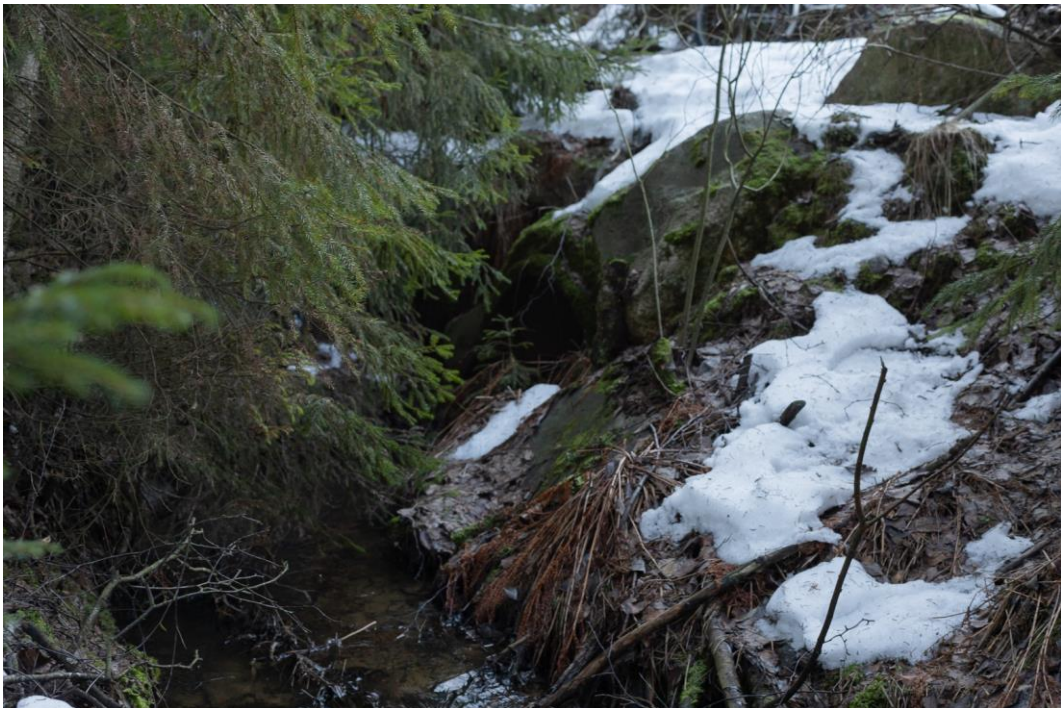
Kuva 174. Betonirumpu Sköldvikin radalla, kilometrillä 54. Rummun yli, ratapenkereen vierellä, kulkee myös ilmeisesti rakennusaikaisen työmaatien ura. Mikko Itälahti 2.1.2023.
