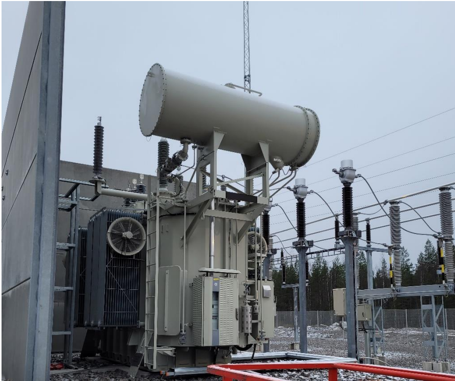
Kuva 5. Tuulivoimapuiston pienempi 110/33 kV muuntaja (kuva Ramboll Finland Oy).
