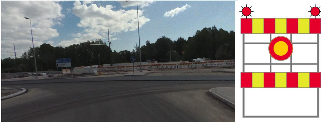
Kuva 48. Mankkaan eritasoliittymän sillalta otettu kuva. Edessä näkyy Raide-Jokerin työmaa. (vasen). Toimintaympäristöluokan S2 pystyjuovainen sulkuaita (oikea) (Liikennevirasto, 2018b, s. 15).
