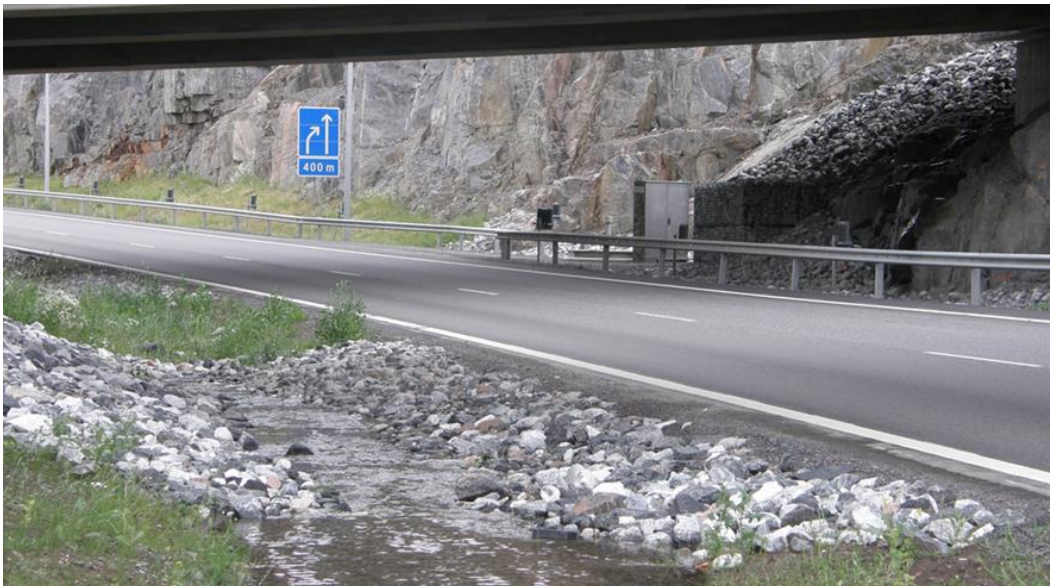
Kuva 26. Kirismäen eritasoliittymän sivuojaan virtaavaa pohjavettä. Tien toisella puolella pumppaamo. Valokuva: Jasper Tainio 2022.
