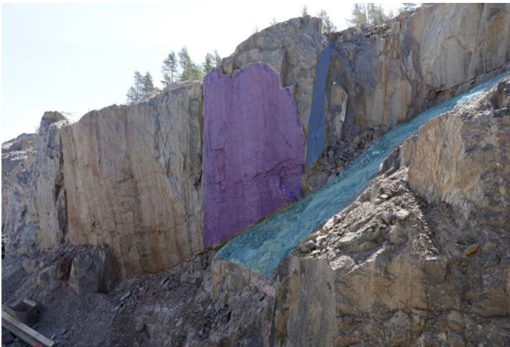
Kuva 24. Esimerkkikuva Kausela–Kirismäki E18:n kallioleikkauksissa esiintyvistä tasomurtumista. Tieväylän suuntaan viettävää rakopintaa pitkin on pudonnut suurikokoinen kalliolohko. Muokattu Ranta-ahon ja Howettin (2020: 3) valokuvasta.
