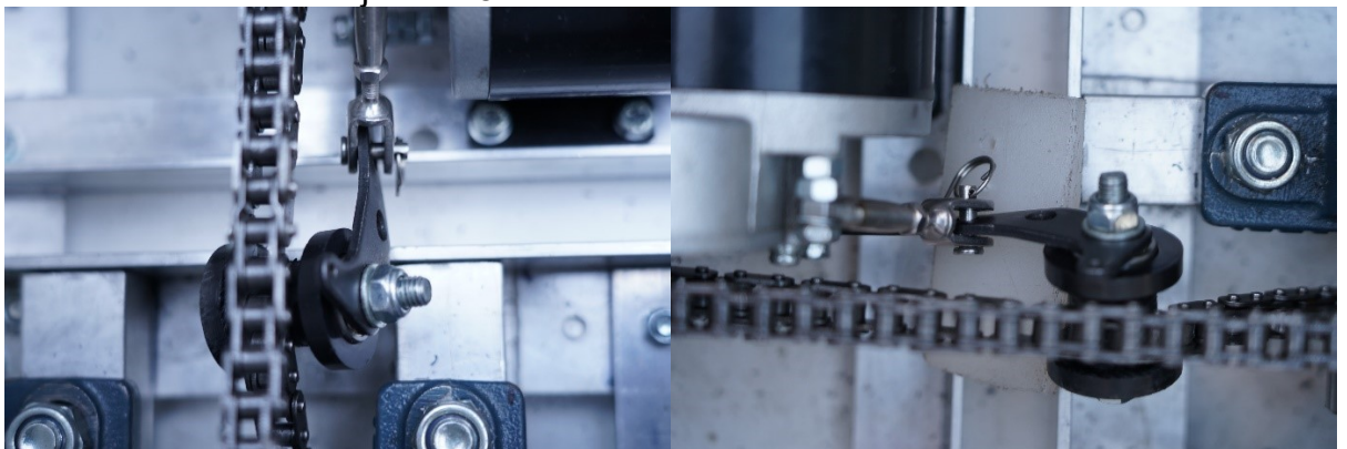
Kuva 3. Yksi vääntyneistä ketjunkiristimistä sekä väliaikainen korjaus kiilaamalla kiihalla mallia 1.
