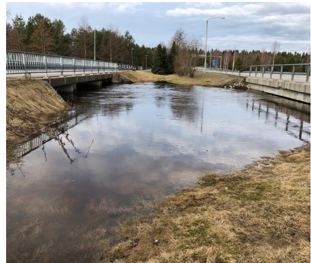
Bild 9. Våröversvämningen i Alavo 20.–22.4.2018. Riksväg 18 och gång- och cykelvägen i norra delen av Vähäjärvi. (bild: Alavo stad)
