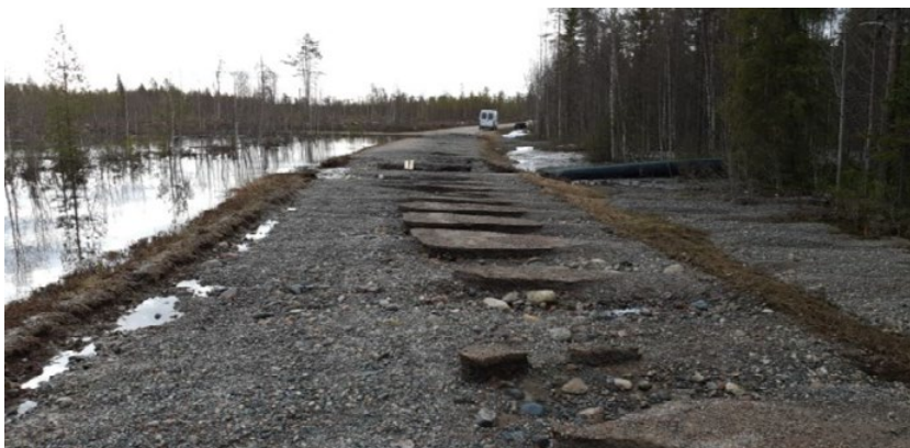
Kuva 6.11. Tulvan vaurioittama tie (kuva: Lapin ELY-keskus).
