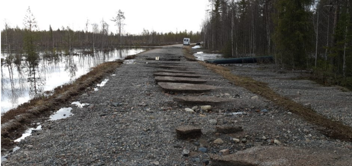
Kuva 29. Tulvan vaurioittama tie (kuva: Lapin ELY-keskus).
