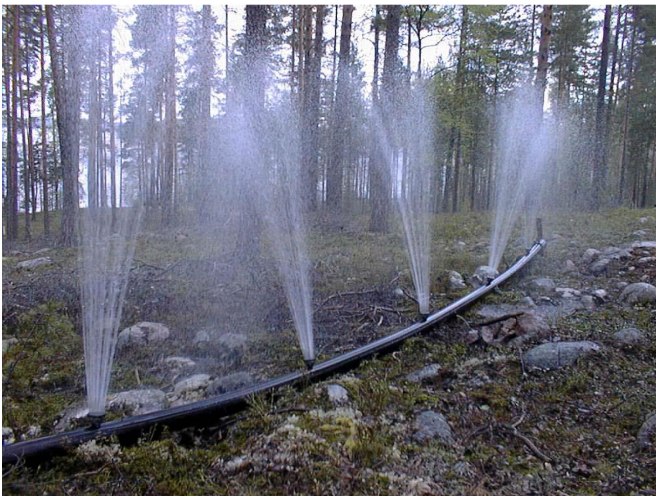
Suuren vedentarpeen tyydyttämiseksi joudutaan myös valmistamaan tekopohjavettä pintavettä imeyttämällä (kuva: Kari Illmer).
