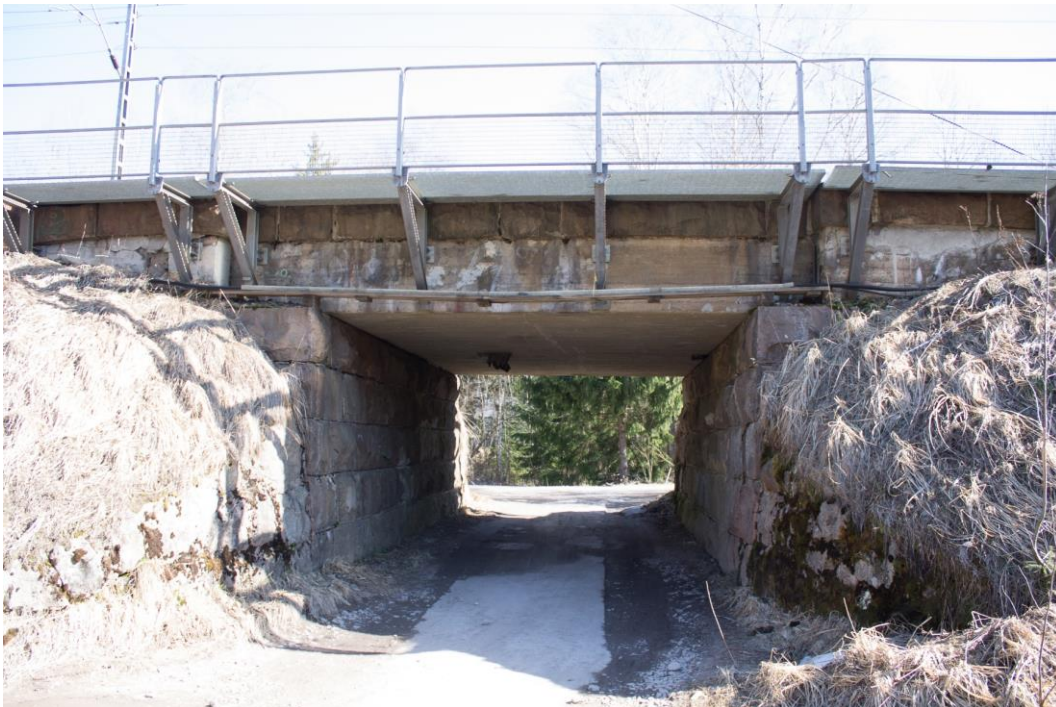
Kuva 7. Tyyneläntien alikulku. Tietason alla kulkee vanha rumpu ojalle. Kuva: Roosa Ruotsalainen/Suomen Rautatiemuseo.
