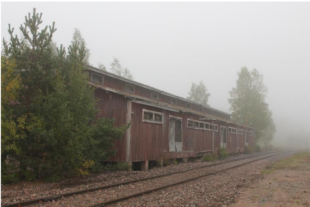
Kuva 28. Uudenkylän ratapiha-alueella on huonokuntoinen makasiinirakennus. Kuva: Roosa Ruotsalainen.
