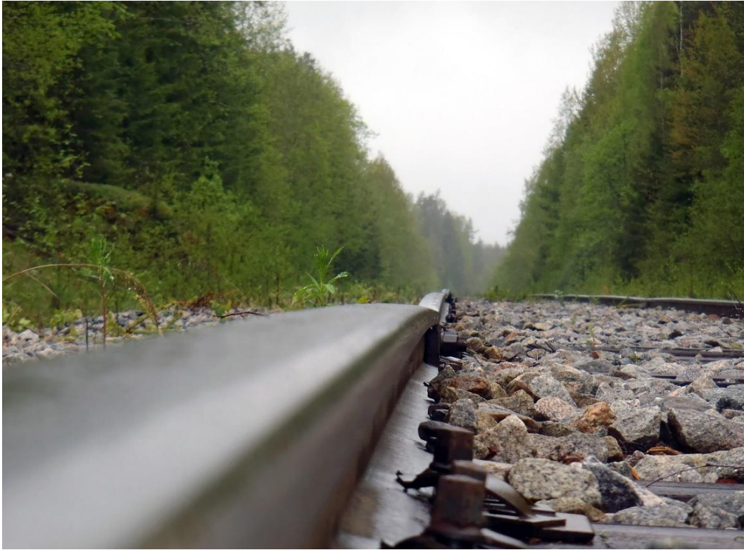
Kuva 47. Voimakkaasti painuneita kiskonjatkoksia Mynttilä–Ristiina-radalla. Kuva: Janne Sorsa
