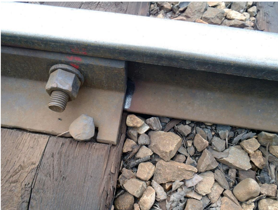
Kuva 90. Huollettu jatkos Ämmänsaaren radalla. Huollossa jatkos avataan ja vaihdetaan komponentteja tarpeellisilta osin. Samalla suoritetaan myös jatkoksen ja kiskon välin rasvaus. Toimenpide vaatii merkittävästi henkilöresursseja. Kuva: Janne Sorsa.
