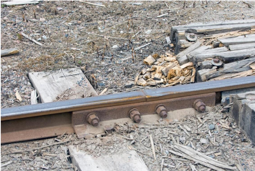
Kuva 25. Huonolaatuisessa soratukikerroksessa pölkky elää, eikä enää ole tukevasti kiinni siinä. Kuvan jatkoksessa on lievästi lätistynyt kiskon pää eikä jatkosrakoa ole. Oikeassa reunassa näkyvä radanpitäjän vastuulla oleva tasoristeyslankutus on elinkaarensa loppupuolella.
