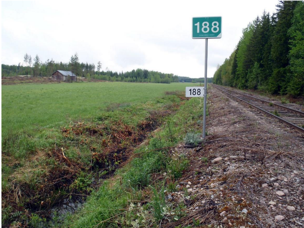
Kuva 6. Radan kuivatuksen kannalta tärkeässä asemassa on mm. sivuo- ojien toimivuus. Ojan kasvaessa umpeen, veden virtaus heikkenee ja viimein loppuu. Vesi kuitenkin löytää aina reitin ja pahimmillaan huuhtoo ratapenkan pois tieltään. Kuva: Janne Sorsa.
