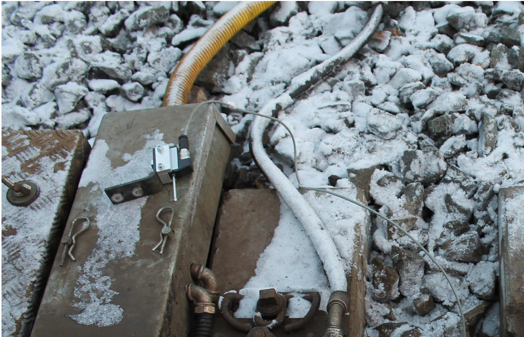
Kuva 20. Kielen ja tukikiskon korkeuseroa mittaava siirtymäanturi kiinnikkeineen ennen asennusta.
