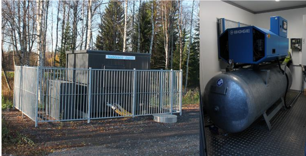
Kuva 7. Paineilmasäiliön ja kompressorin laitteistotila ulkoa ja sisältä vaihteen V331 vieressä.
