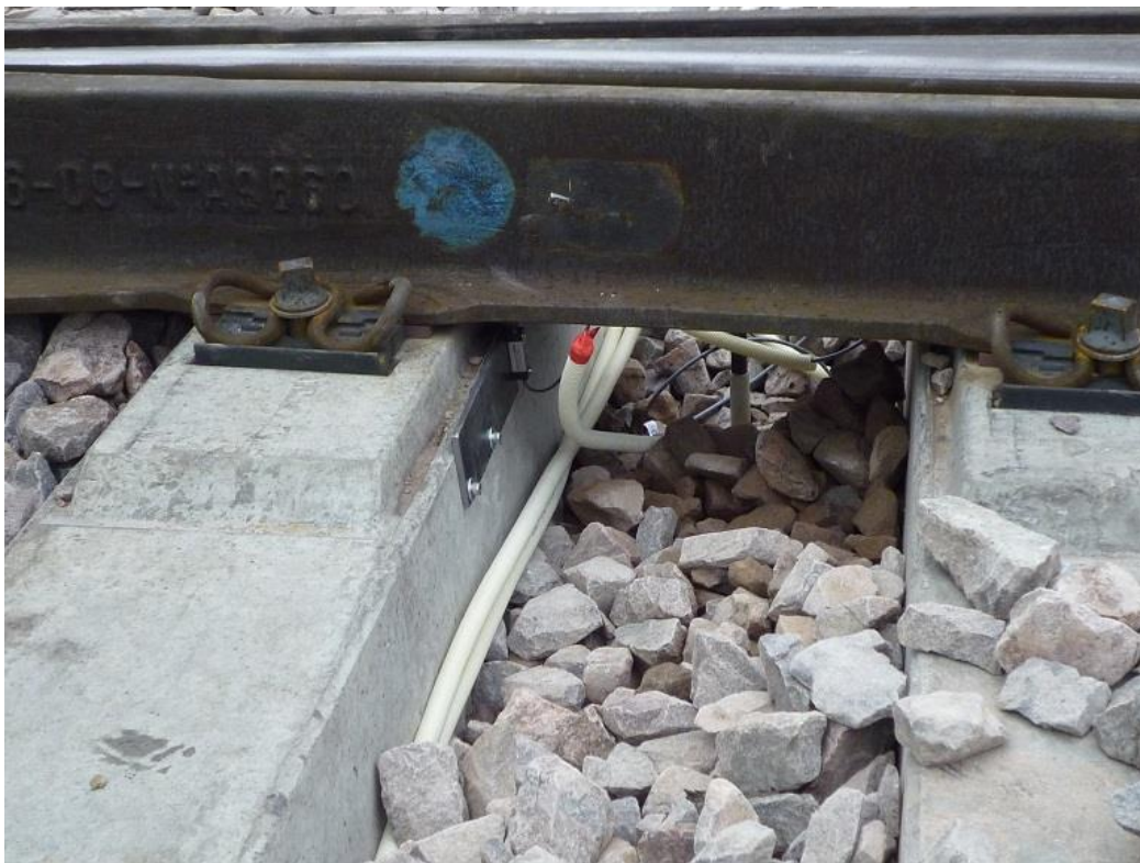
Kuva 12. Kiskon ja pölkyn välisen liikkeen mittaava anturi risteysosan alla.
