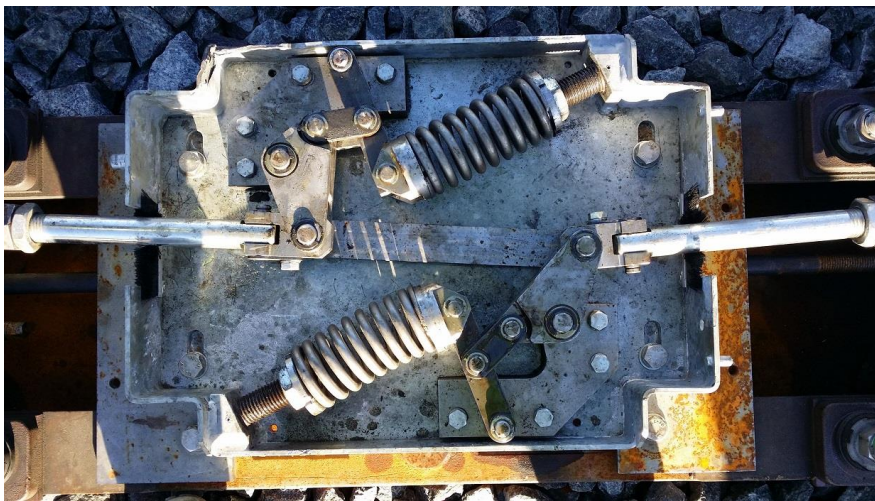
Kuva 72. Kaukalopölkyn väärästä asemasta johtuva kantakääntöavustimen kääntötankojen vinous vaihteessa V331.
