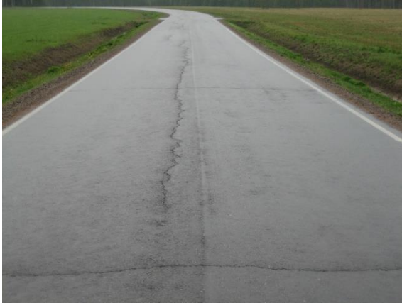
Kuva 15. Yt 14547. Ohuita pituus- ja poikkihalkeamia asfalttipäällysteessä (15.5.2007 Harri Jyrävä).
