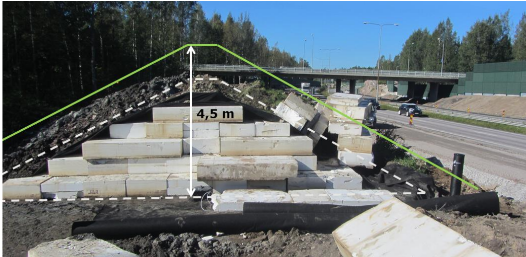
Kuva 51. EPS kevennetyn meluesteen rakentaminen. Katkoviivalla on esitetty suunnitelmien mukainen ytimen raja. Vihreällä yhtenäisellä viivalla on esitetty meluesteen lopullinen muoto. Maatiivisteiden paksuus ytimen ympärillä on 1,0 m. (Napari 2017)
