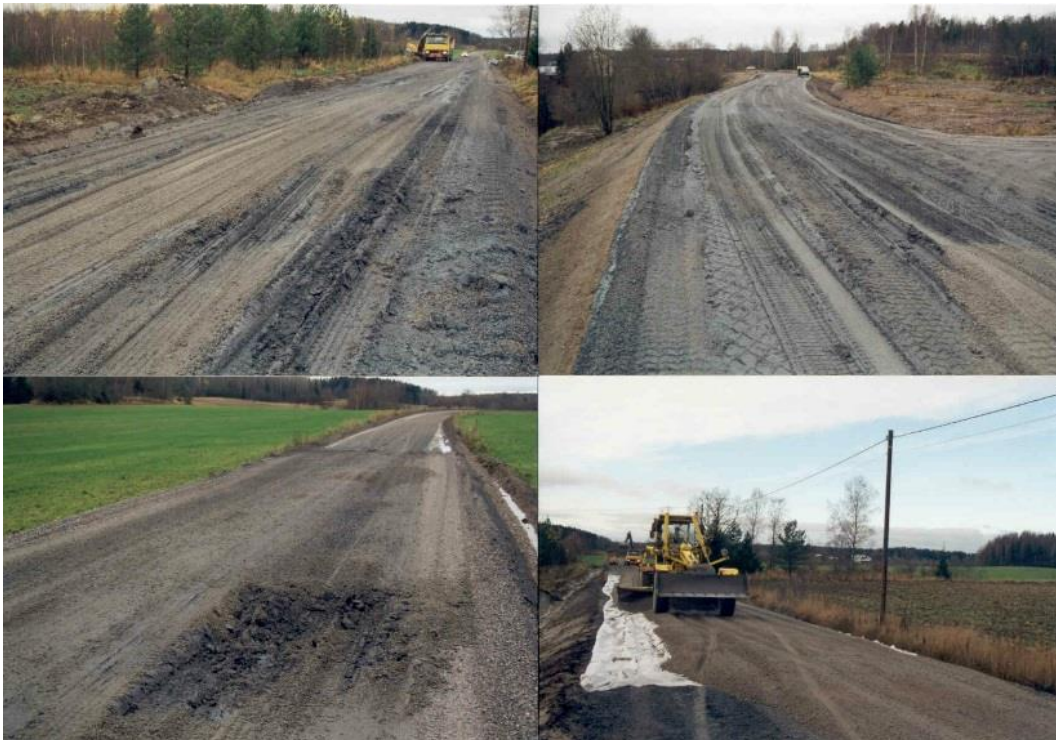
Kuva 10. Yt 11146. Stabiloitujen lento- ja kuitutuhkaosuuksien pehmenemistä vauriot tiivistämisestä seuraavina päivinä ja vaurioiden korjaustyö. (Ahlqvist et al. 2000).
