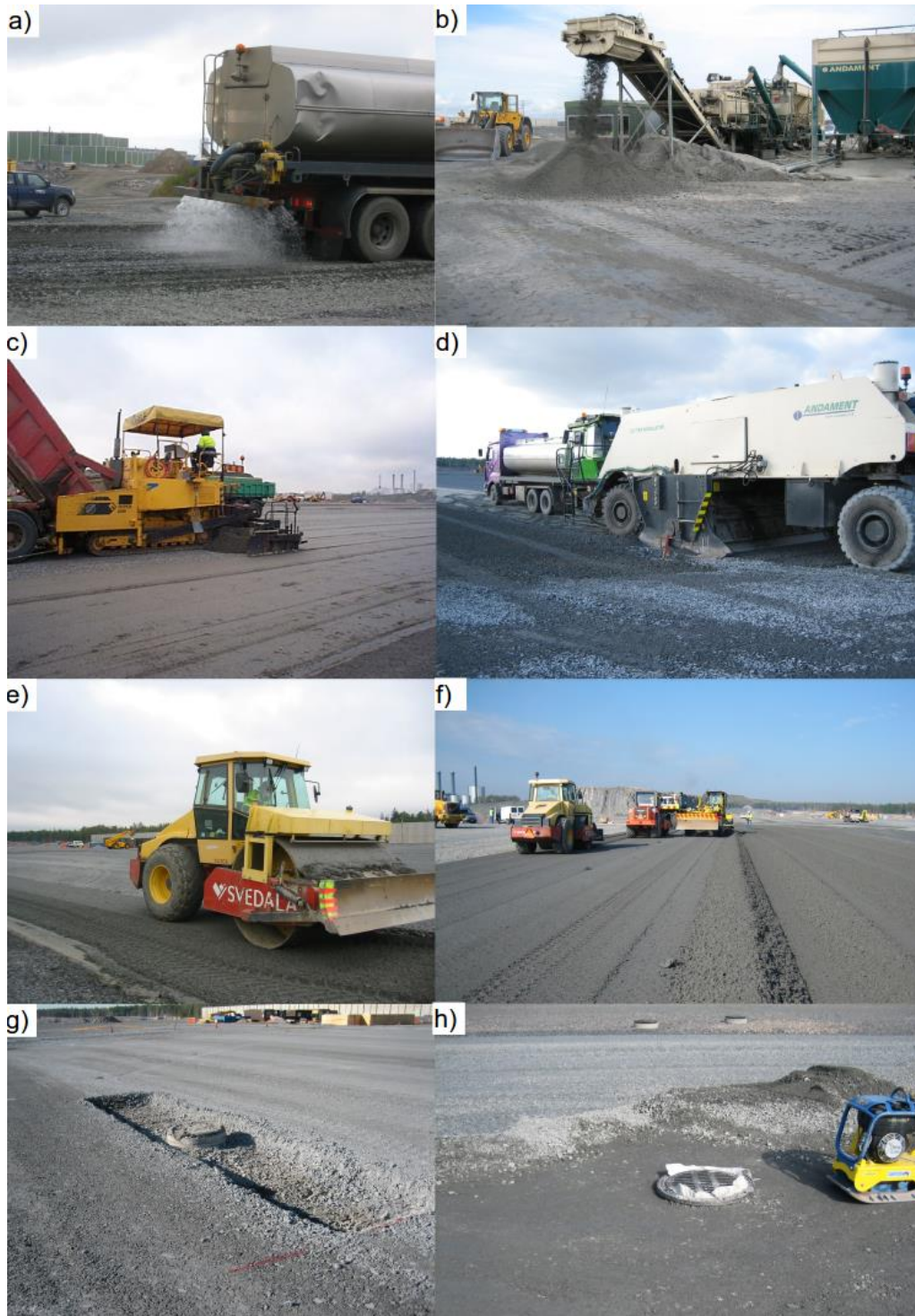
Kuva 107. Vuosaaren satama. Rakentamisvaiheen valokuvia. a) stabiloitavan murskeen kostuttaminen säiliöautolla, b) sideaineseoksen valmistus asemasekoittimella, c) sideaineseoksen levitys asfaltinlevittimellä, d) sideaineseoksen ja murskeen sekoitus stabilointijärsimellä e) stabiloidun rakennekerroksen tiivistäminen, f) stabiloidun rakennekerroksen muotoilu ja tiivistäminen, g) kaivon ympäristäytön leikkaus ja h) kaivon ympäristäytön murskeen tiivistäminen tärylevyllä (Ronkainen & Sikiö, 2007).
