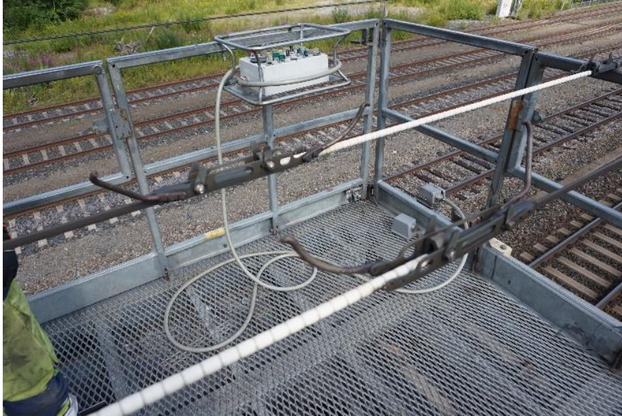
Kuva 10. Ryhmyseristimellä kohtaavat kytkentäryhmät, valokaaren sieppaussarvet sekä valkoisena näkyvät eristävät osuudet.
