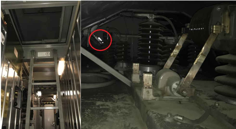
Kuva 23. RSRU sijaitsee fyysisesti veturin ylälaitetilassa.
