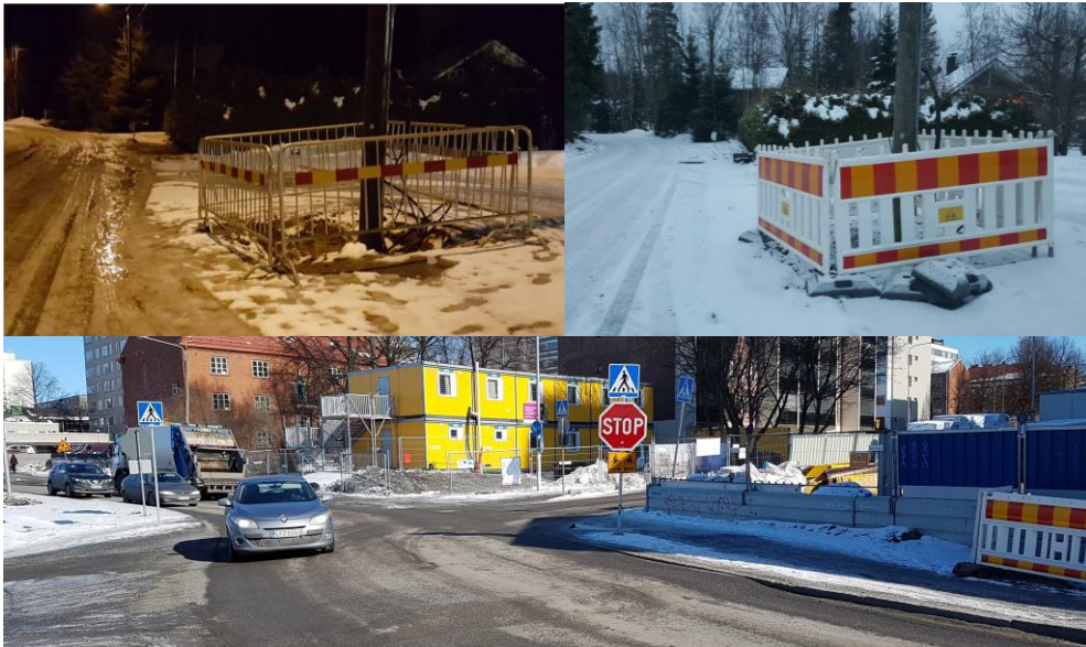
Kuva 8. Muovisen ja metallisen työaidan näkyvyydessä on iso ero. Muovisen aidan osalta tulee huomioida, ettei sitä asenneta niin, että muodostuu näköeste. Suojatien yhteydessä tulee käyttää aitaa, josta näkee läpi sivusta tulevat jalankulkijat ja pyöräilijät.
