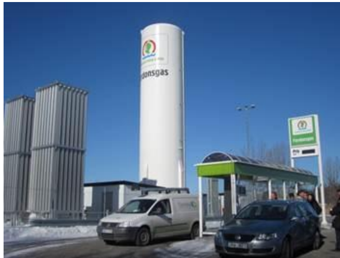
Kuva 15. Esimerkki biometaanin jakeluasemasta, kaasuvarasto maan pinnalla pystyasennossa.
