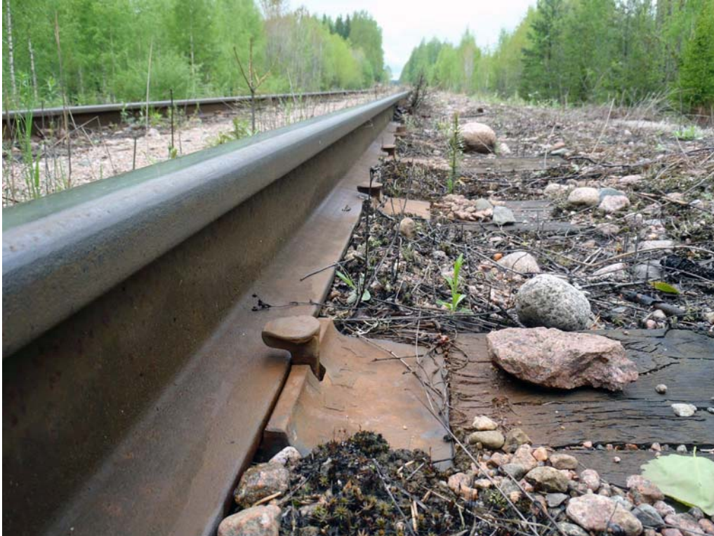
Kuva 9. Huonolaatuisessa soratukikerroksessa rata elää ja sen seurauksena naulakiinnitysten naulat nousevat irti kiskosta. Ajan ja pölkyn pehmenemisen myötä myös kiskon aluslevy painuu pölkyn sisään liikenteen vaikutuksesta. Naulauksen väljenemisen vuoksi naulan lyöminen uudelleen pohjaan on vain hyvin lyhytaikaisesti tilannetta parantava ratkaisu. Kuva: Janne Sorsa.
