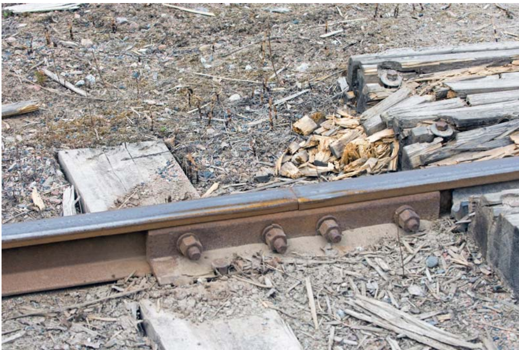
Kuva 27. Huonolaatuisessa soratukikerroksessa pölkky elää, eikä enää ole tukevasti kiinni siinä. Kuvan jatkoksessa on lievästi lätistynyt kiskon pää eikä jatkosrakoa ole. Oikeassa reunassa näkyvä radanpitäjän vastuulla oleva tasoristeyslankutus on elinkaarensa loppupuolella.
