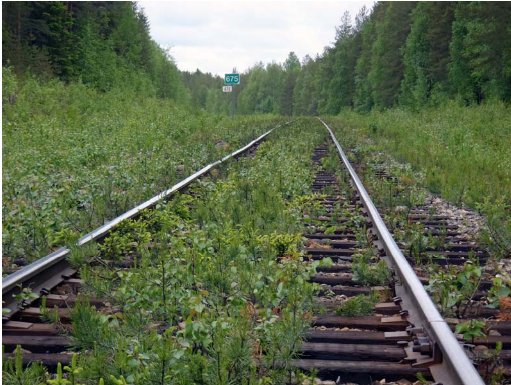
Kuva 79. Eräin paikoin lähtökohtaisesti sorapohjaisilla radoilla on merkittävästi kasvustoa, jonka mekaaninen tai kemiallinen poistaminen ei käytännössä ole kestäväällä tavalla mahdollista. Kuvassa näkyvää karkeampaa raidesepeä tukikerroksessa on vain ohuelti. Kuva: Janne Sorsa.
