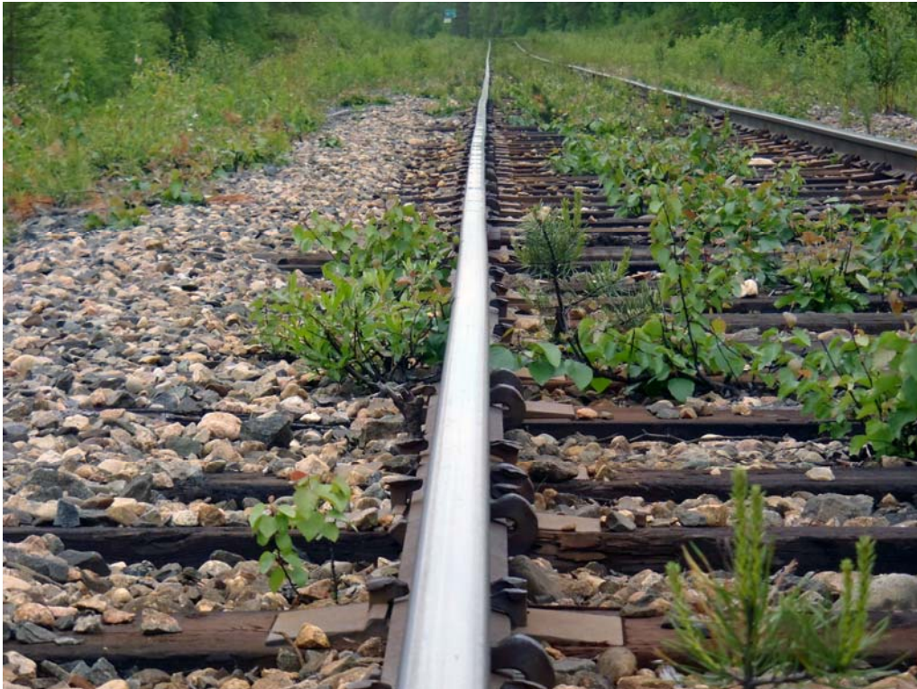
Kuva 81. Ratakiskossa esiintyvä kylmämuokkautuminen näkyy silmämääräisesti kiskon pinnan aaltoiluna. Kuva: Janne Sorsa.
