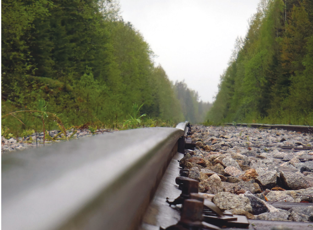
Kuva 53. Voimakkaasti painuneita kiskonjatkoksia Mynttilä–Ristiina-radalla. Kuva: Janne Sorsa
