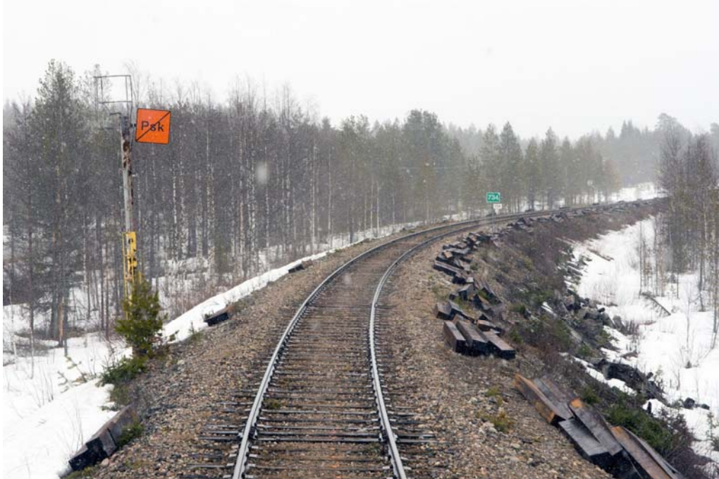
Kuva 80. Turvallisen liikennöitävyyden varmistamiseksi vaihdettiin toukokuussa 2017 lauttavaihtona kaikki ratapölkkyt Pesiökylän Ämmänsaaren suunnan lähtökaarteesta.
