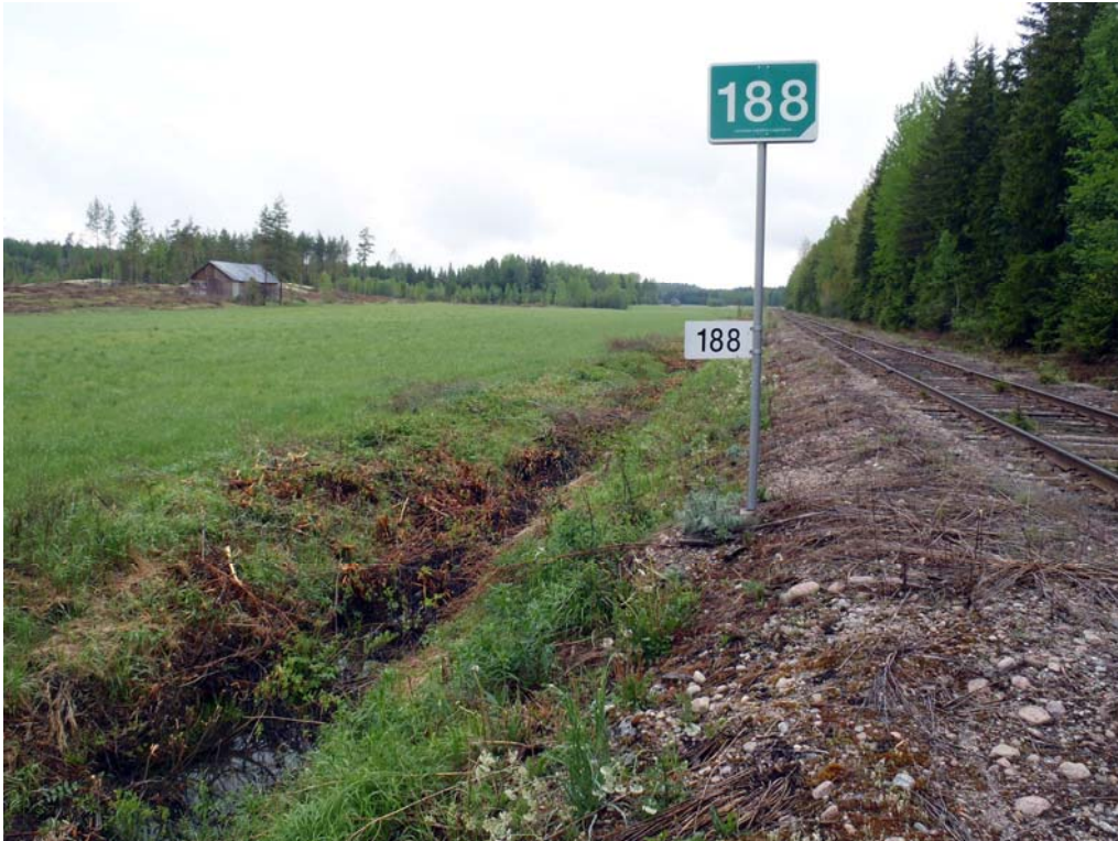
Kuva 6. Radan kuivatuksen kannalta tärkeässä asemassa on mm. sivuojen toimivuus. Ojan kasvaessa umpeen, veden virtaus heikkenee ja viimein loppuu. Vesi kuitenkin löytää aina reitin ja pahimmillaan huuhtoo ratapenkan pois tieltään. Kuva: Janne Sorsa.
