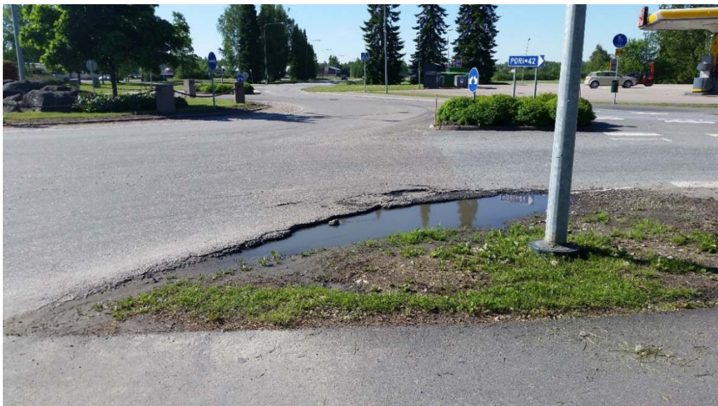
Kuva 21. Kulunut piennar pohjoisen ja lännen liittymähaarojen välissä Kauvatsan- tien kiertoliittymässä.
