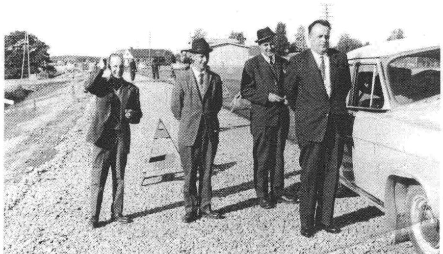
Vt.3 Ruto - Pada päällystäminen v. 1962, Oy Viarecta Ab. Vas. rkm. K. Ohvo, rkm. M. Bonn, autonkuljettaja B. Belfolk ja DI Paavo Luoma. Kuva: J. Sorvari
