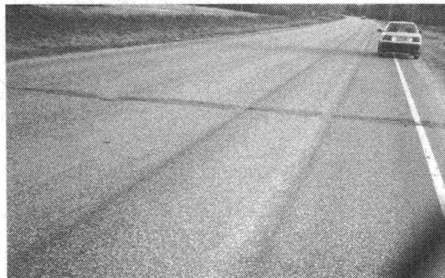
Raiteistunutta ajorataa v.1987. Kuva: J. Rapila
