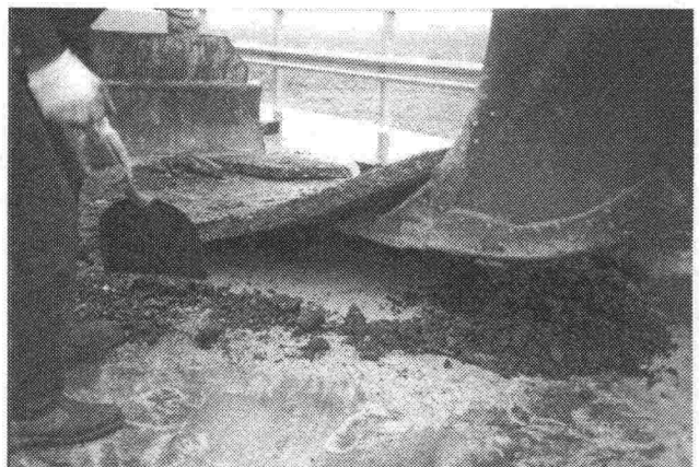
Vassorin sillankanteen vt.8:lla ei asfaltti tarttunut. Kuva: J. Rapila
