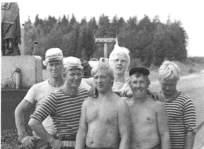
Tehoasfaltti Oy:n levitystyöryhmä v. 1976. Kuvassa oik. yhtiön tuleva rakennuspäällikkö J. Rantanen. Kuva: J. Rantasen kokoelmasta
