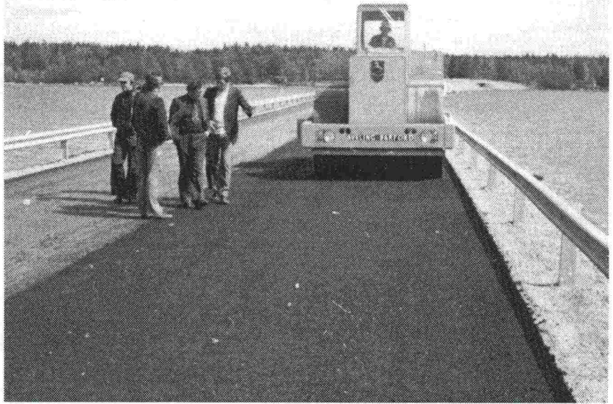
Tehoasfaltti Oy päällystää Raippaluodon pengerrystietä v. 1973. Vas. ins. A. Rintatalo, rkm. J. Rapila, rkm. P. Hyyppä ja DI J. Salonen. Kuva: J. Rapilan kokoelmasta
