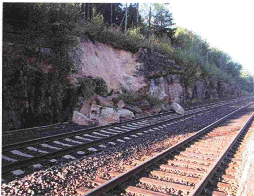
Kuva L6.6 Kivitukimuuuri, jonka kuormitus on lisääntynyt ajan myötä yläpuolisen tien liikennemäärän kasvaessa. Lopulliseen sortumaan on mahdollisesti myötävaikuttanut eroosio, vesi, jäätyminen/sulaminen -syklit sekä mahdollisesti vielä läheisten louhintatyömaiden aiheuttamat lisärasitukset.
