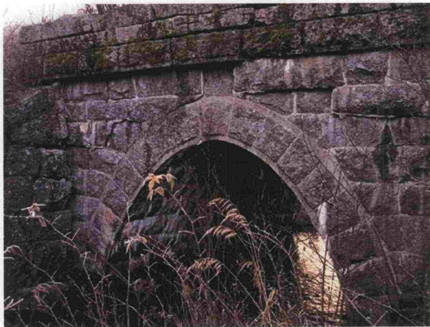
Kuva L6.5 Hyväkuntoinen kiviholvisilta ja vanhempi kiviholvisilta, joka ei välttämättä kestä louhintatärinän aiheuttamia äkillisiä siirtymiä yhtä hyvin.
