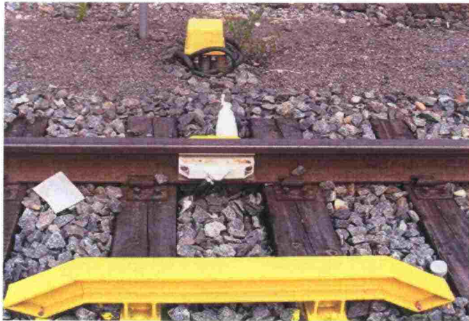
Kuva L6.16 Akselinlaskenta-anturi on kuvassa keskellä kiskon kyljessä. Keltainen metalliosa edessä on anturin auraussuoja. Taustalla on keltainen kytkentälaatikko.
