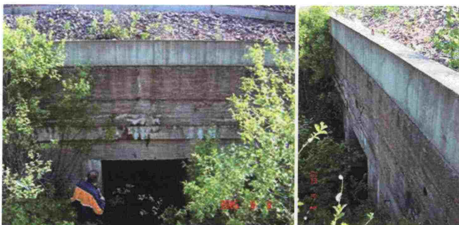
Kuva L6.9 Teräsbetoninen kehäsilta, jonka reunapalkkia on korotettu useampaankin kertaan. Alimmissa korotuskerroissa alkaa jo näkyä kapasiteetin ylittymistä.
