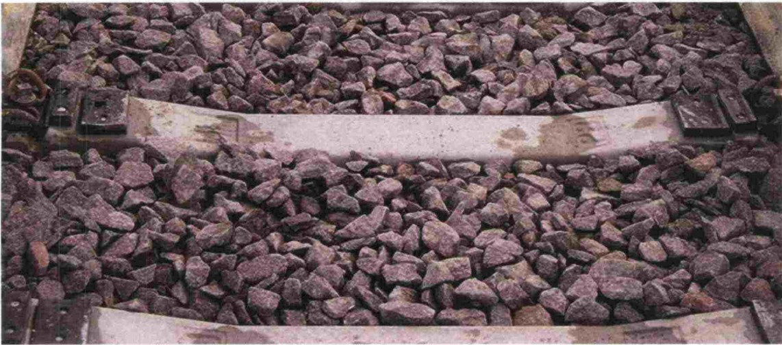
Kuva 53. Betonikansi laippaurakumineen on suojannut tukikerrosta, vaikka olosuhteet olivat erittäin vaativat.
