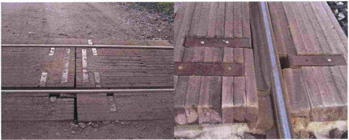
Kuva 5. Ankkurointi päältä kiinnitettynä ja laippaurakumia haittaavana.
