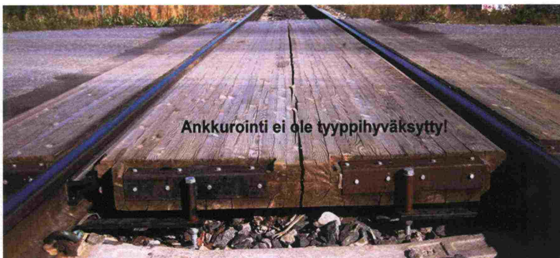
Kuva 31. Kannen halkeaminen johtuu tyyppihyväksymättömästä ankkurirakenteesta, josta puuttuu riittävät pelivarat.
