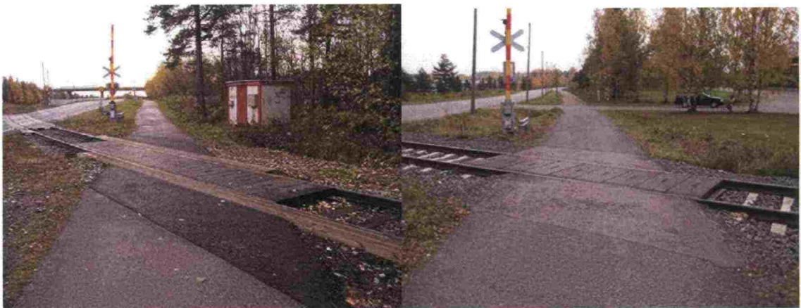
Kuva 75. Laippaurattomuudella turvallisuutta vinossa tasoristeyksessä.
