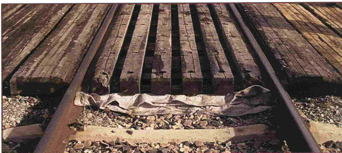
Kuva 65. Ensimmäinen moottorikelkkatasoristeyks. Rakenne ei ole uutena hyväksyttävä. Uusi rakenne on keskielementin osalta umpinainen.
