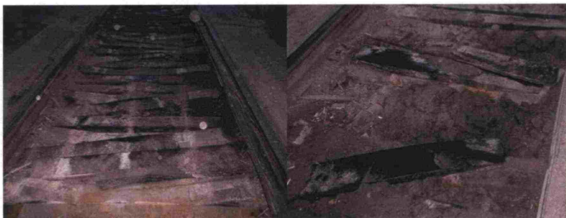
Kuva 19. Kumiset betoniratapölkkyjen korotuselementit eivät aina pysy paikoillaan.
