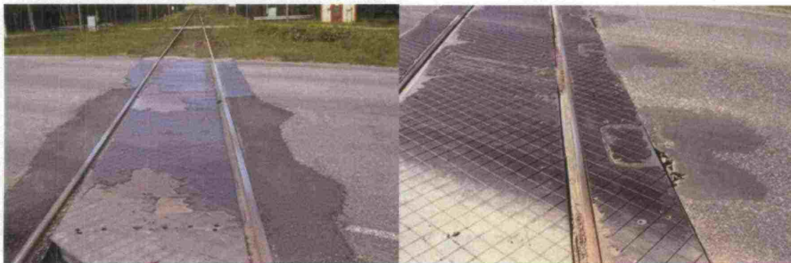
Kuva 60. Metallinen tasoristeyskansirakenne, jota ei uutena hyväksytä.
