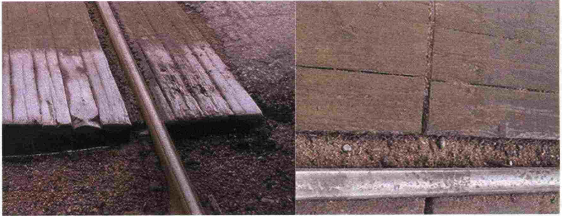
Kuva 70. Laippaura täyttyy, jäätyy ja muuttuu raideliikenteen turvallisuusriskiksi.
