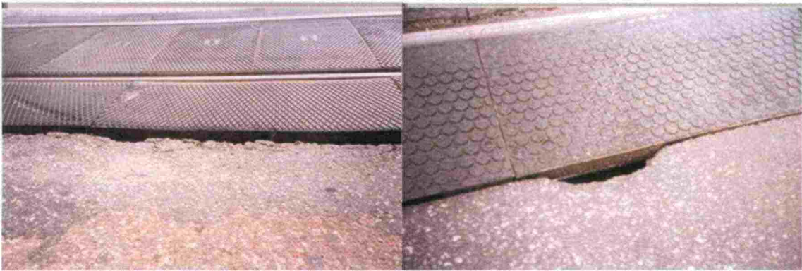
Kuva 12. Reunan lohkeamalla on taipumus laajentua.
