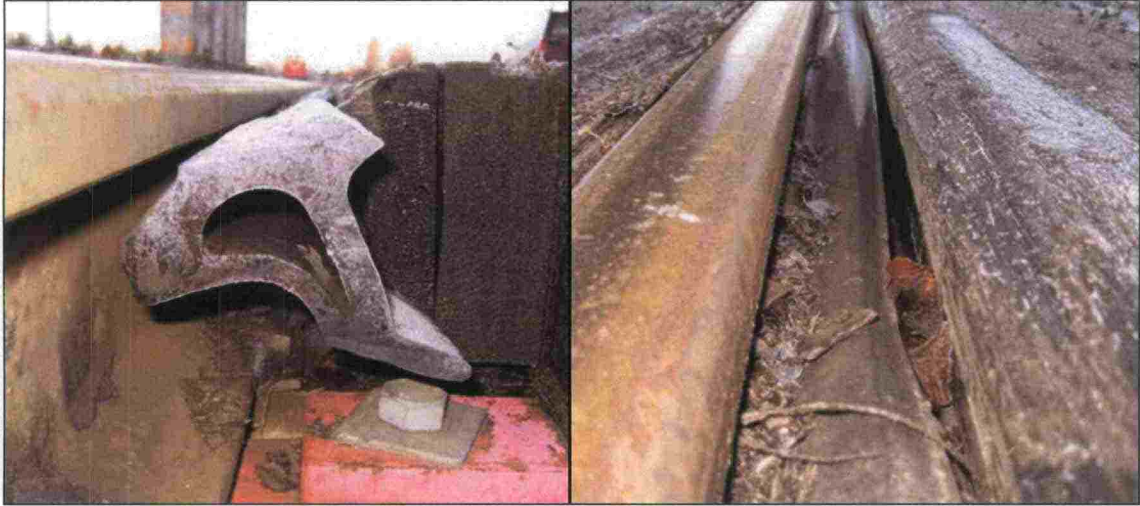
Kuva 11. Vanhanmallinen laippaurakumi 'kaatuu' alas eikä nouse. Roskaa ja kiviä pääsee laippauraan, jossa laippaurakumi ei toimi.
