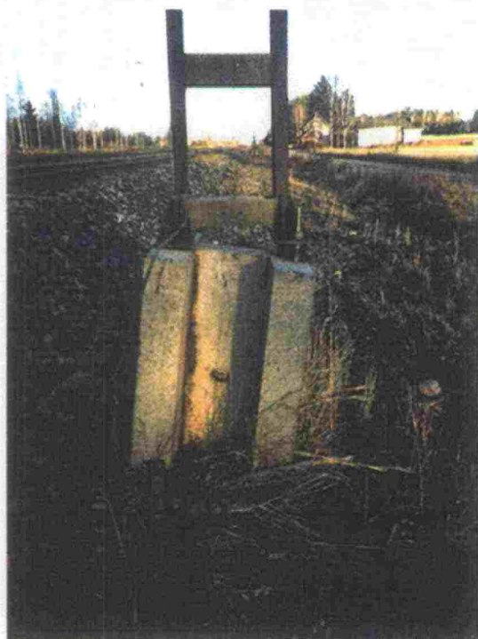
Kuva 10.3. Kallistunut pylväsperustus. (Lähde: RHK)
