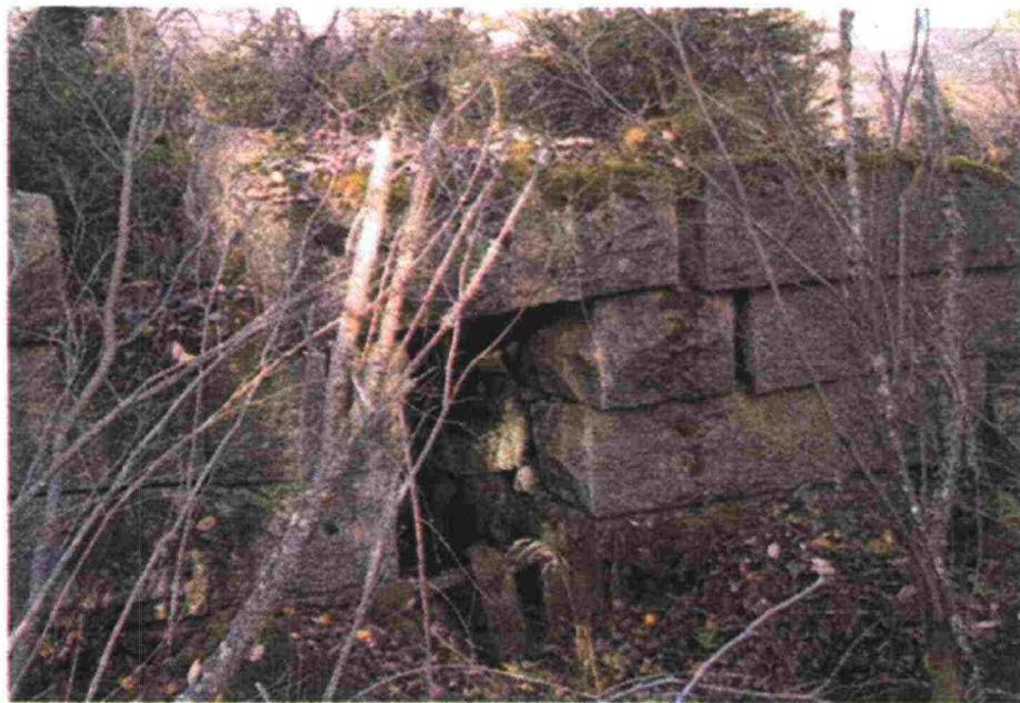
Kuva 8.1. Heikkokuntoinen kivrumpu. Rummun kivet ovat siirtyneet ja rummun uoma on tukkeutunut. /14, s. 13./
