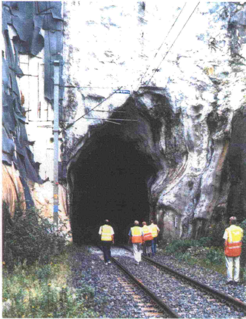
Kuva 11.1. Huonokuntoinen tunnelinsuu. Vasemmalla vaurioituneita veden- ja lämmöneristeitä, oikealla ruiskubetonoinnin lohkeilua.
