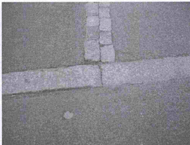
Kuva 15. Upotettu reunakivi liittymässä.
