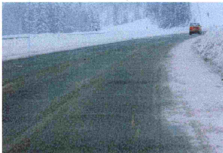
Kuva 34. Epätasaisia kohoumia talvella 1998 E4 vid Höga Kusten Bro tiellä Ruotsissa (kuva Höpeda 1999a).
