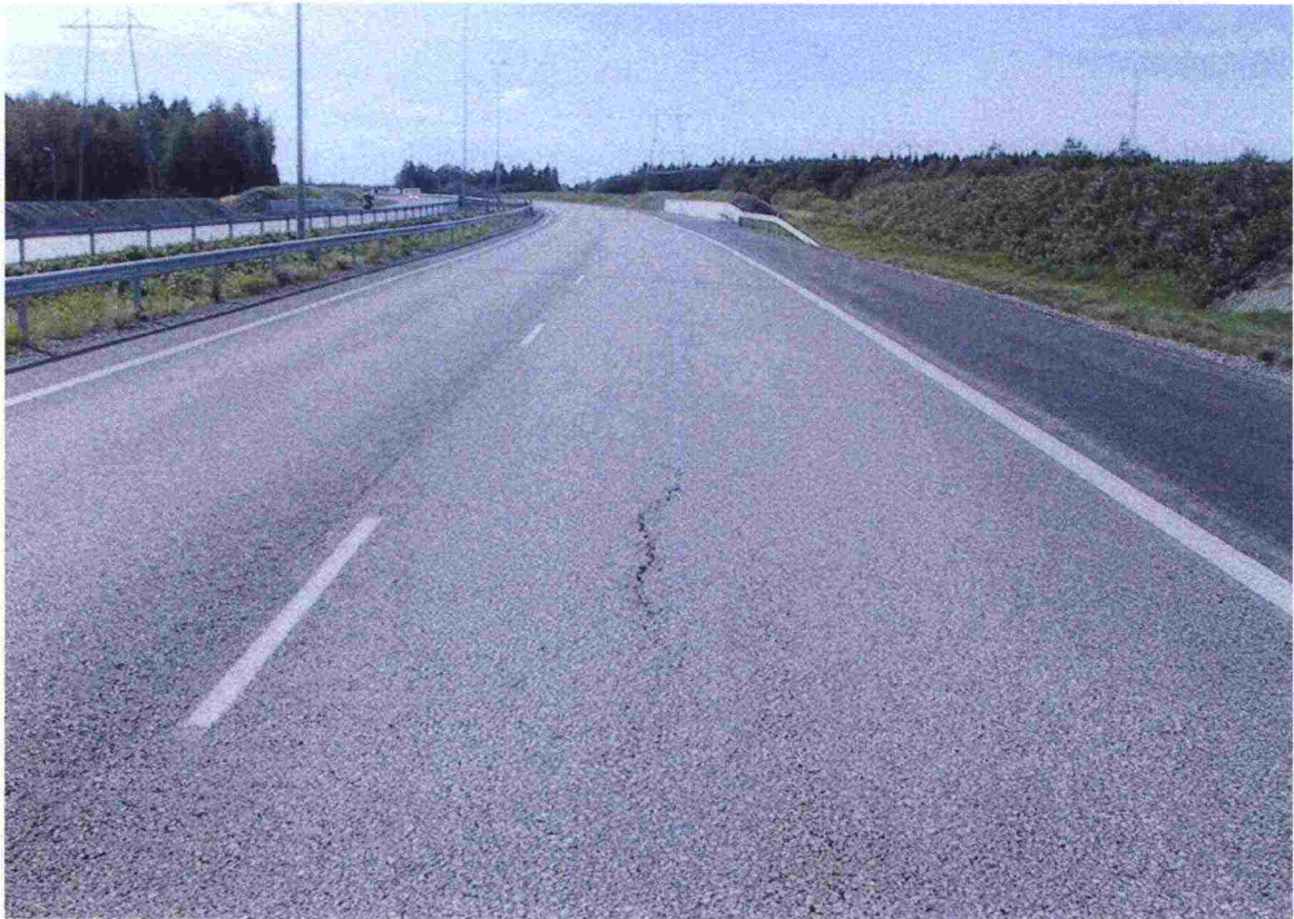
Kuva 18. Esimerkki pituushalkeamasta Tornio – Kemi suunnan paalulta n. 4000 m. Pituushalkeaman kohdalla havaittiin talvella myös kapeaa saumahalkeamaa.
