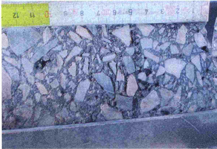
Kuva 35. Poranäyte paalulta 15 768. Välillä 45 – 80 mm voidaan nähdä sideaineen alkavaa irtoamista kivirakeista. Näytteen vesipitoisuus oli 4,1 %.
