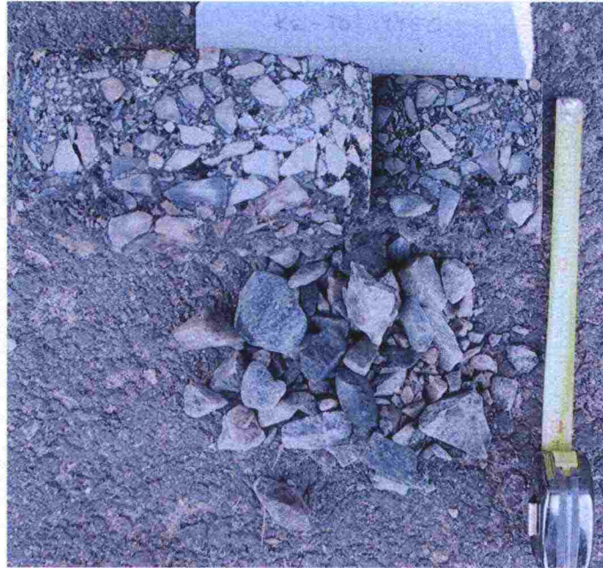
Kuva 24. Halkaisijaltaan 100 ja 200 mm:n poranäytteet paalulta 4450 m suunnasta Kemi – Tornio. ABK:n alapuolella oleva BST oli käytännössä murentunut. Huomattavaa on että porareistä kaivetut kivet olivat lähes puhtaita eikä bitumia tavattu edes pienempien kivien pinnalta. Sidotun kerroksen pp-laitetuloksista takaisinlaskettu moduuliarvo oli tällä kohdalla vain 1165 Mpa.
