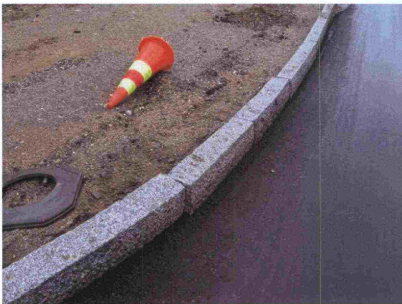
Kuva 3. Keskustan kohdalla ajoradan reunassa on graniittinen reunakivi.
