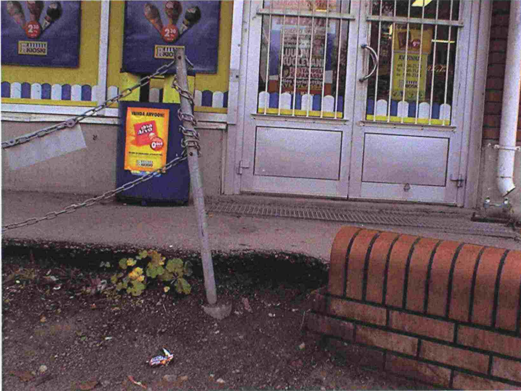
R-kioskin edustalla on vaarallinen jyrkkä reuna, joka aiheuttaa putoamisvaaran kaikille liikkujille.
