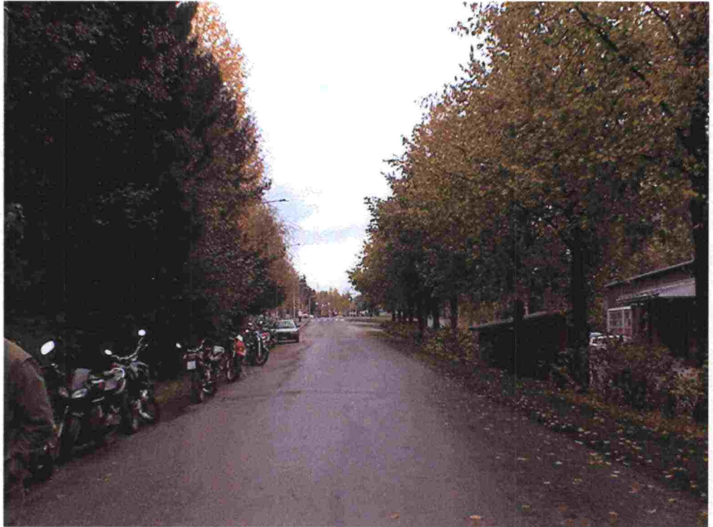
Kuva 28. Ritonpohjantieltä koululle johtavan väylän päällyste on paikoin huonossa kunnossa. (Kohdenumero 76).
