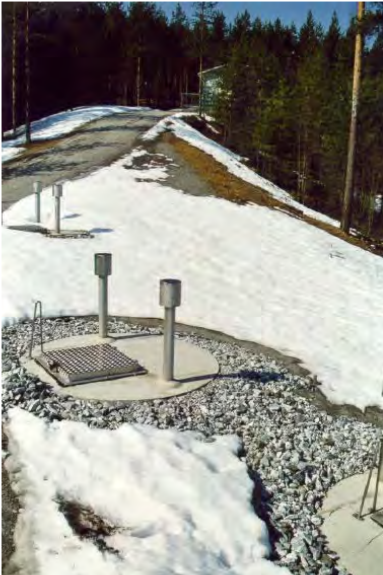
Kuva 2. Kirkkokankaan vedenottamon siiviläputkikaivot
