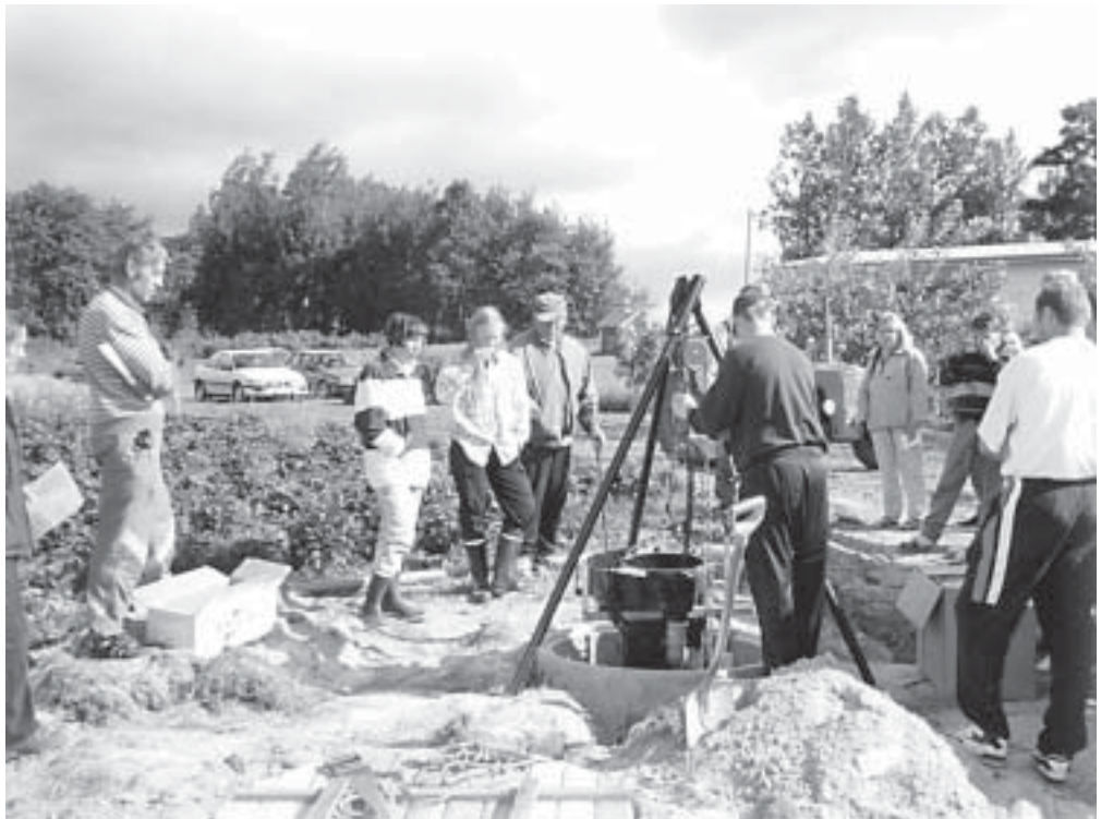
Kuva 9. Ensimmäinen Lappajärvi Life –hankkeessa rakennettu mallikohde oli Valio Ollin tilalle tehty Ecoplast-puhdistamon prototyyppi.
