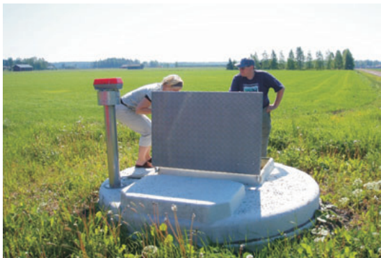
Kuva 11. Vesiosuuskunta Suonen painekorotusasema (Hanna Yli-Tolppa).
