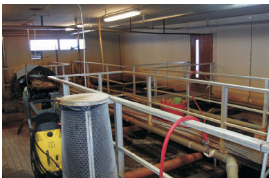
Kuva 10. Kirveskosken jätevedenpuhdistamo (Hanna Yli-Tolppa).
