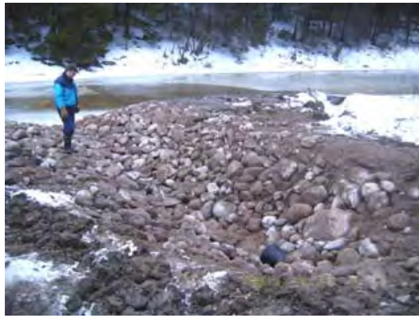
Kuva 27. Ruhalan oja suisto kivettiin syöpmisen estämiseksi. Kiveyksen alle asennettiin suodatinkangas. Kuvassa toinen Ruhalan alueen maanomistajista, Timo Rekola.
