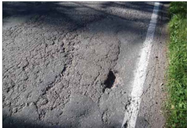
Tien vauriokohtia Kuvat Laura Soosalu.
