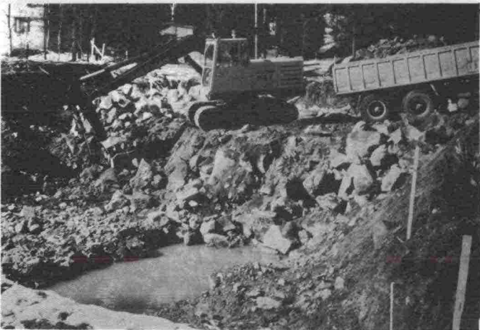
KUVA 4. Louheen kuormaus. Perustukseen tehdään louhepatja (vas.) ja rumpua varten arina- tila (oik.).
