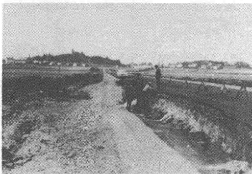
Kuva 1. Maanvaraisesti rakennetun penkereen sortuma
