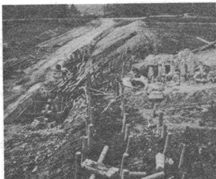
Kuva 3. Luiskan sortumaluonteinen liikkuminen näkyy puupaalurivien käyristymisenä.
