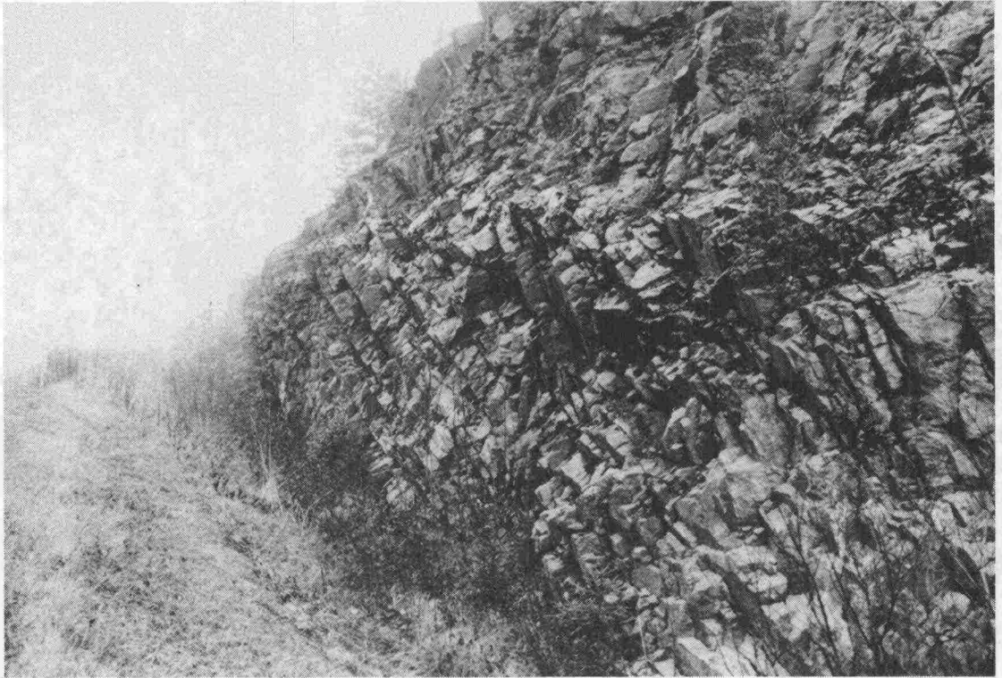
Valokuva 7. Epätasainen louhintajälki tiheärakoisessa kalliossa. Vallitsevan rakoilun suunta ja kaade epäedullinen leikkaussuuntaan nähden.
