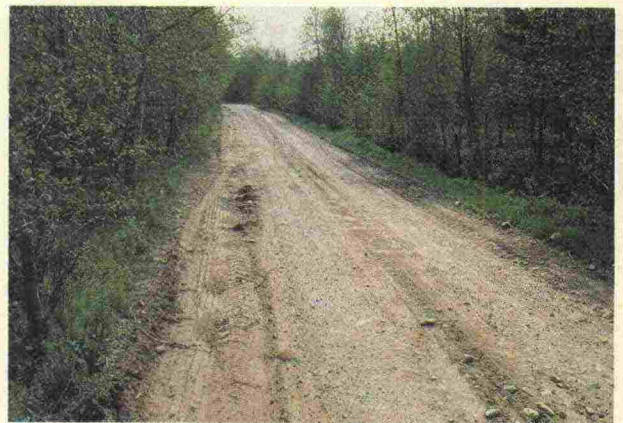
Fig. 14. Dränering, sidodiken Dikena i dåligt skick, 0 poäng (skala 3-0).
