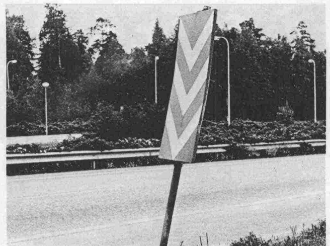
Kuva 2.41 Yksivartinen erkanemismerkki taittunut
