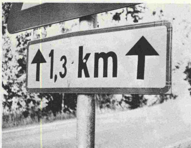
Kuva 2.16 Aivan uusi lisäkilpi vääntynyt
