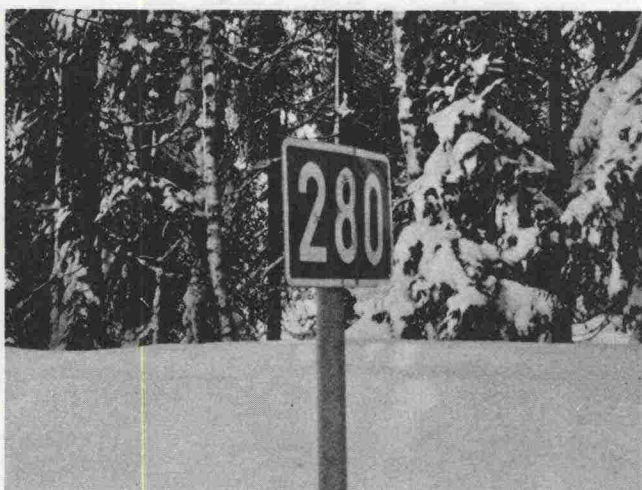
Kuva 2.18 Alumiininen tienumerokilpi vaurioitunut
