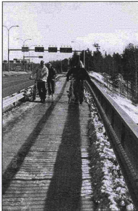
Kuva 128. Pohjantien ongelmallinen ylikulku (kohde 4).
