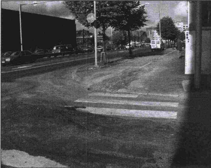
Kuva 20. Esimerkki huonokuntoisesta seurantakohteesta
