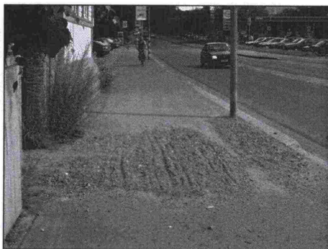
Kuva 58. Pihalta rankkasateen mukana huuhtoutunut hiekka poistettiin ripeästi
