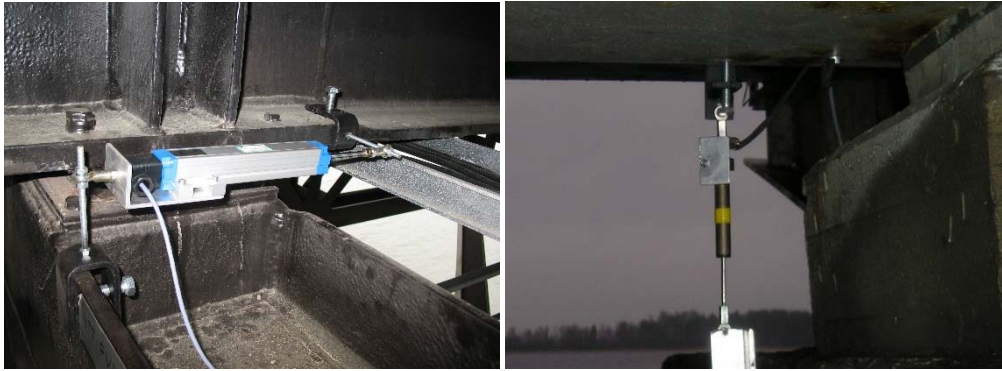
Kuva 6. Mekaaninen liikeanturi asennettuna sillan kannen ja pääristiköiden väliin (vasemmalla) ja sillan laakerin tukipintojen väliin (oikealla)
