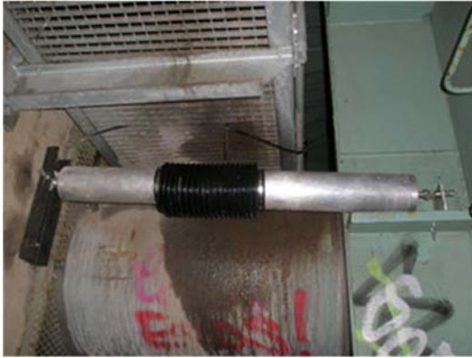
Kuva 8. EX-Large ekstensiometri sillan maatuen ja kansirakenteiden välisten siirtymien mittaamisessa (Lapinlahden silta, Helsinki). Kuva Optimon Oy.
