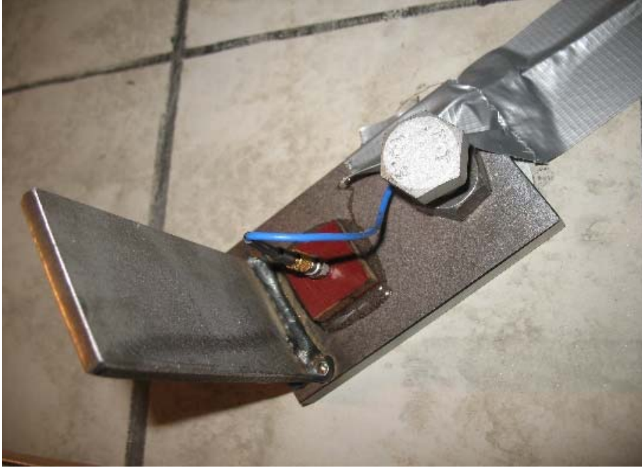
Kuva 16. Betonirakenteeseen kiinnitetty kiihtyvöysanturi.
