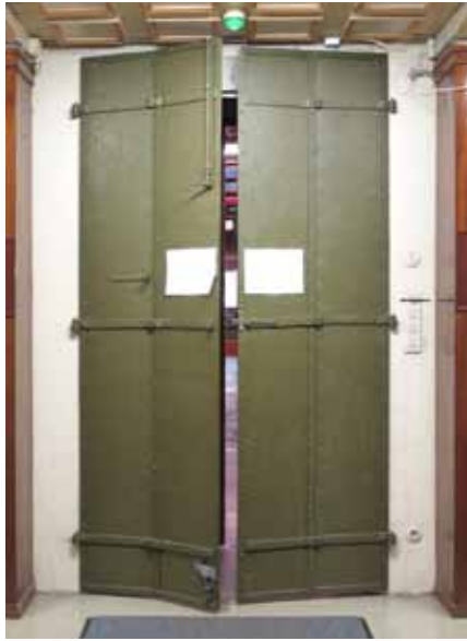
Ovi 1b: Paksusta rautalevystä niittamalla koottu palon-suojaluukku; nykyisin ei käytössä.
