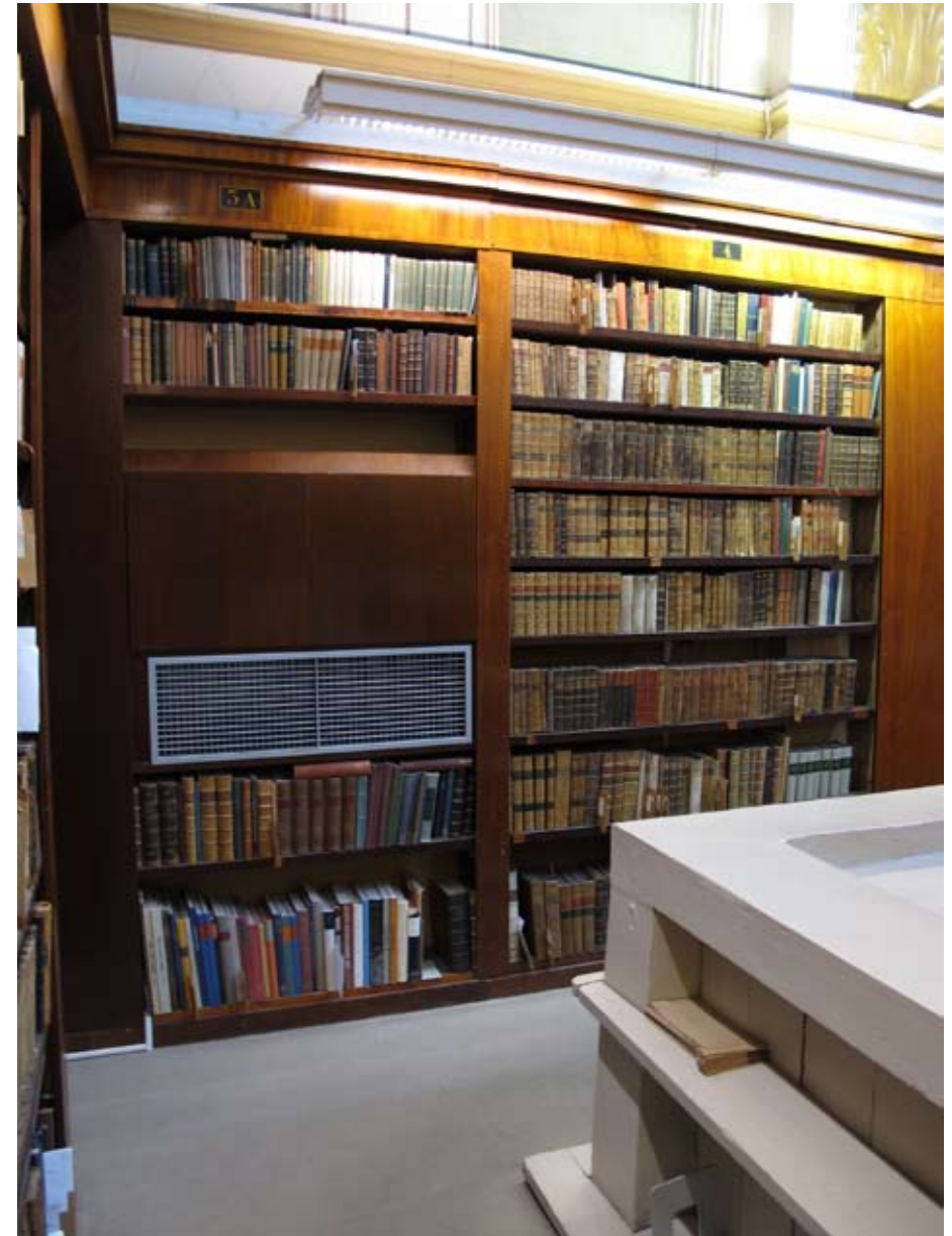
Koko peruskorjauksen vaikeimpia tehtäviä oli ilmanvaihdon ratkaiseminen komeita tiloja turmelematta. Suurien salien ilmanvaihdon pääreitit sijoitettiin kirjahyllyihin. Vaakavedot asennettiin kirjahyllyjen päälle, otasalaudan ja valaisinrampin taakse, jokseenkin näkymättömiin. Ilmanvaihtosäleikköjä sijoitettiin salien nurkkiin siten, että asennustilat peitettiin mahonkiviilutetulla lastulevyllä ja IV-säleiköt ovat paljaana kirjahyllypinnassa. Kuva 2011
