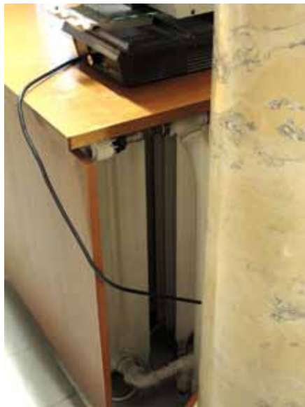
Pohjoissalin pohjoispuolen radiaattoreita on poikkeuksellisesti kaksin kappalein, tietyvästi korkeamman lämmöntarpeen johdosta. Mahonkiviilutetut suojat on 1954-1957 peruskorjauksesta.
